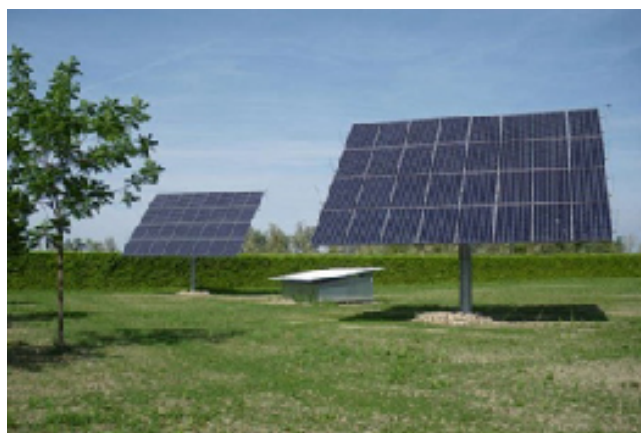
Foto 9 - Impianto fotovoltaico con pannelli ad inseguimento
