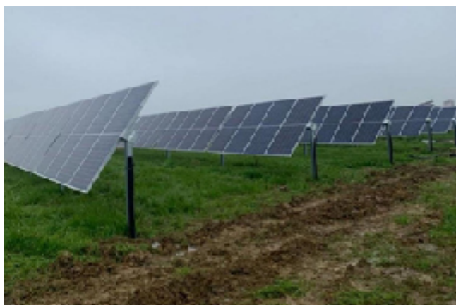
Foto 8 - Impianto fotovoltaico con pannelli ad inseguimento
