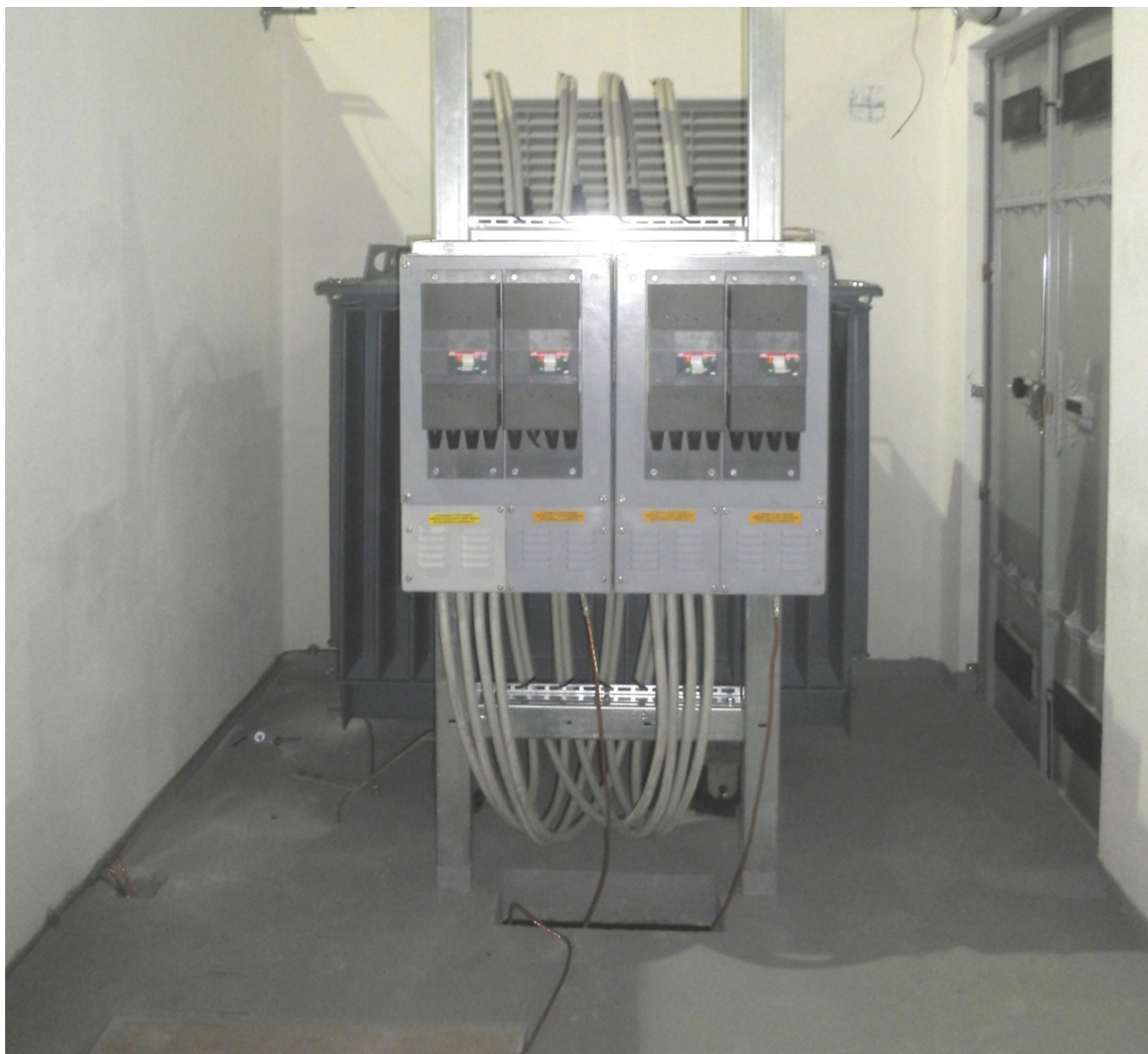
Esempio quadro BT installato
