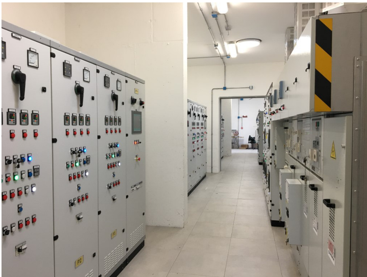
Figura 5 Edificio quadri MT/BT
