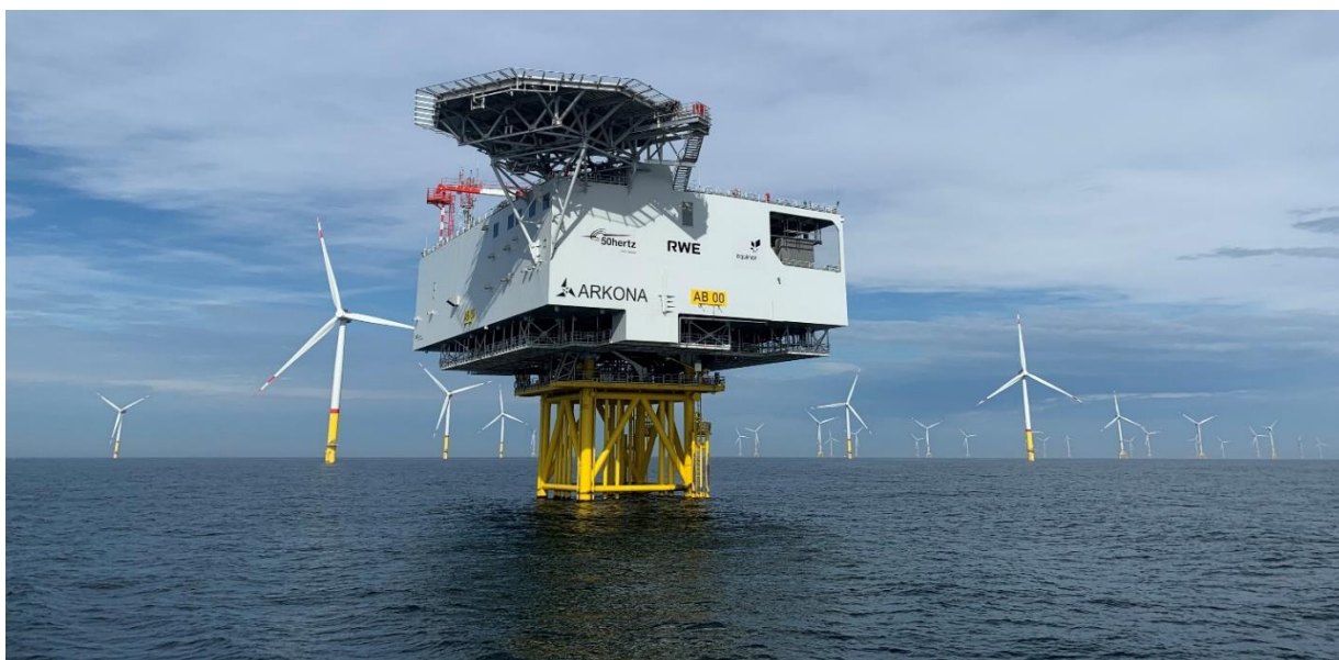
Immagine 4 – Stazione di trasformazione offshore dell'impianto eolico offshore RWE Arkona in Germania
