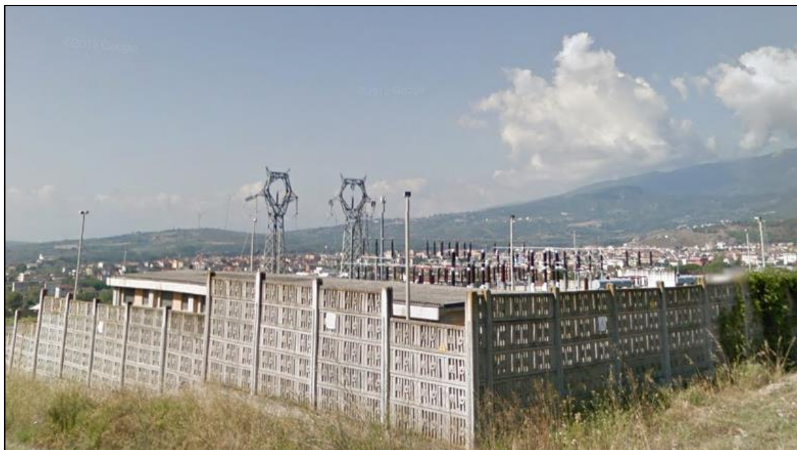
Figura 10- - Cabina di consegna CP Castrovillari (esistente)
