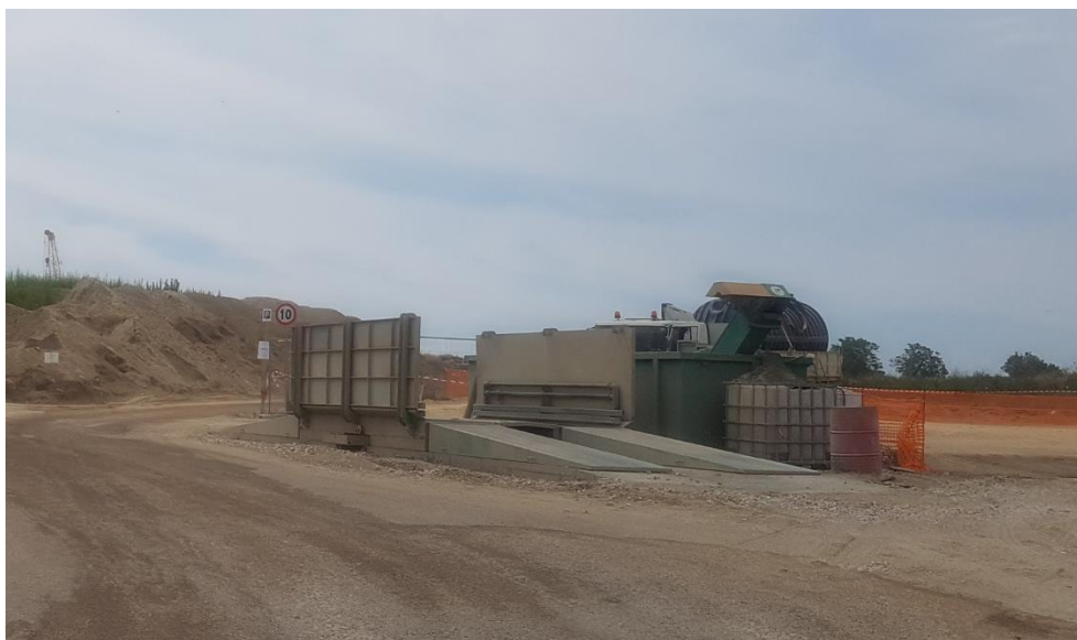
Figura 11 Esempio di impianto automatico lavaggio ruote mezzi d'opera
