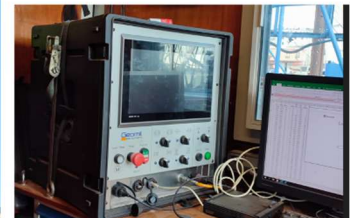
SISTEMA DI CONTROLLO E ACQUISIZIONE DATI
