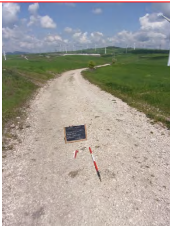
Fig. 19, cavidotto in direzione del sottocampo 4, AN - 04, visto da sud
