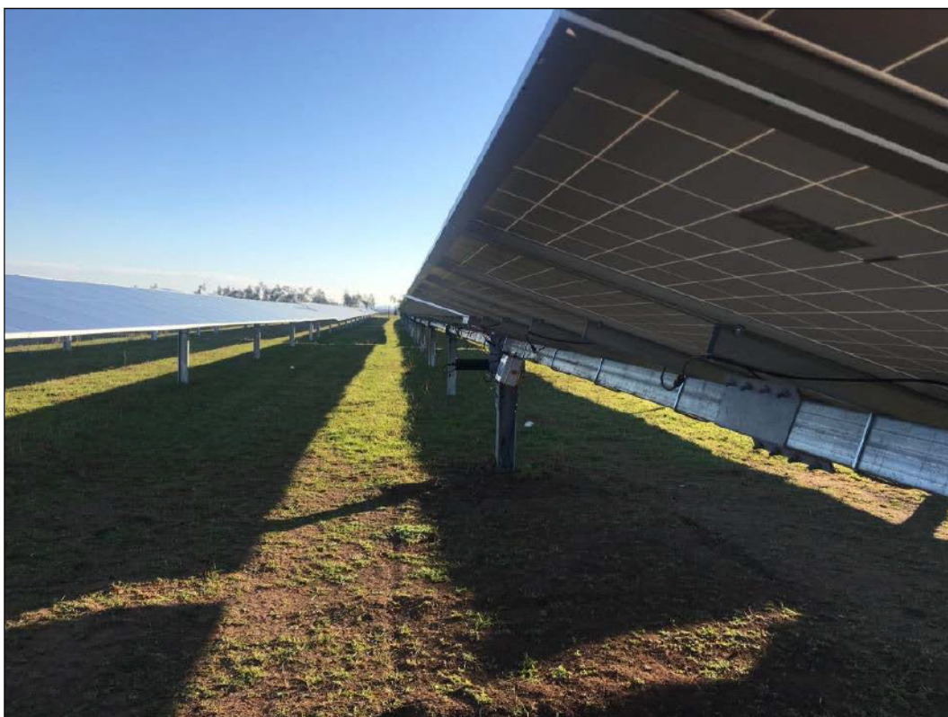
Figura 5. Esempio di installazione di un inseguitore SunHunter.
