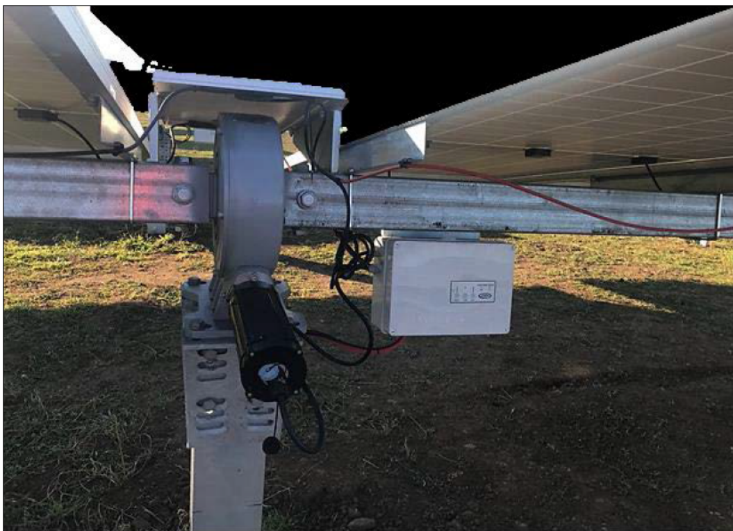
Figura 6. Controller Box di un inseguitore SunHunter.
