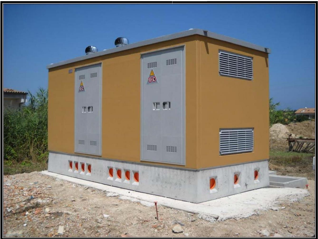
Figura 6 – esempio di cabina di parallelo MT
