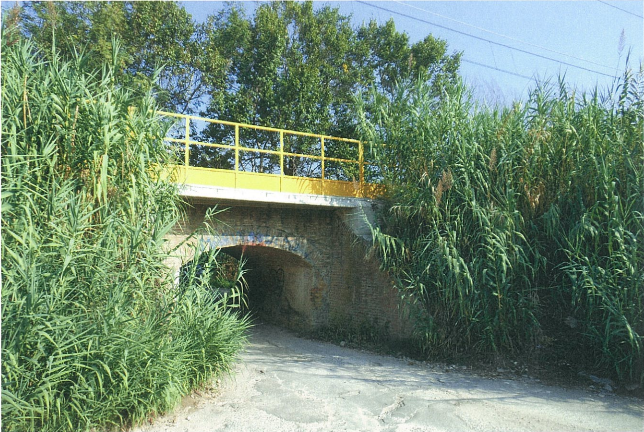
Foto 3 Sottovia non idoneo per dimensioni al transito di mezzi pesanti
