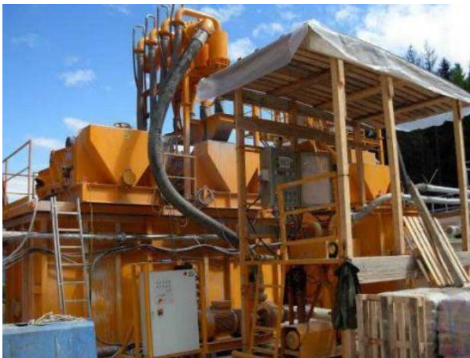
Foto 7.1.11/D - Sistema di disidratazione
