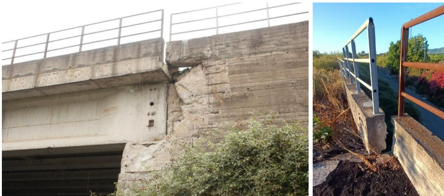
Figura 6 – Lesioni e disassamenti nell’impalcato del sottopasso, riconducibili all’attività della Faglia Fiumefreddo (punto B in Figura 4).
