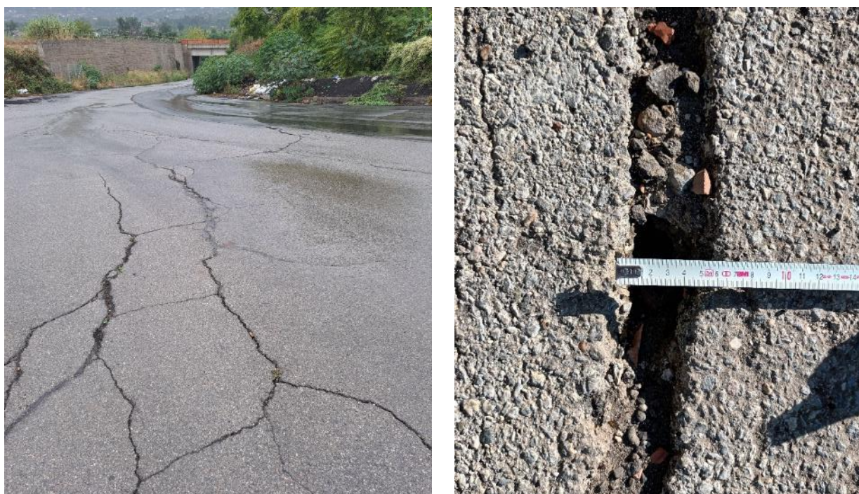
Figura 7 – Crepe nel manto stradale in corrispondenza della faglia (punto C in Figura 4).
