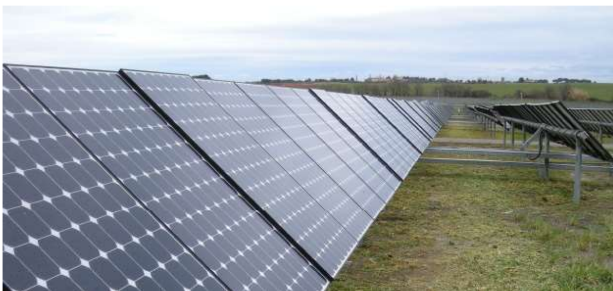
Figura 8 -Stato del terreno inerbito sotto i pannelli fotovoltaici
