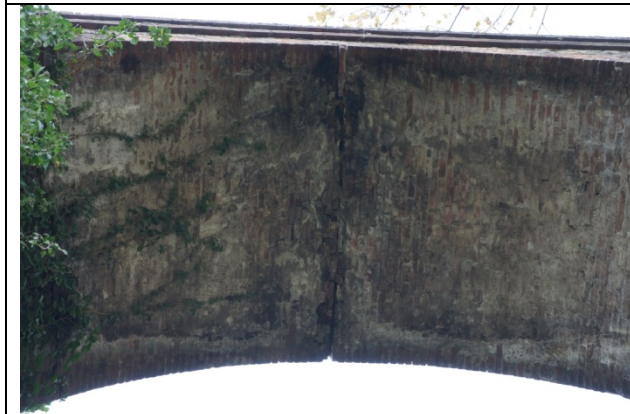
Lesioni in chiave dell'arco terminale
