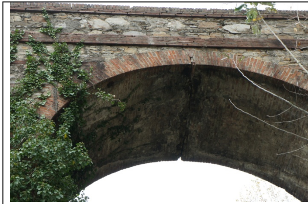
Lesioni in chiave dell'arco terminale
