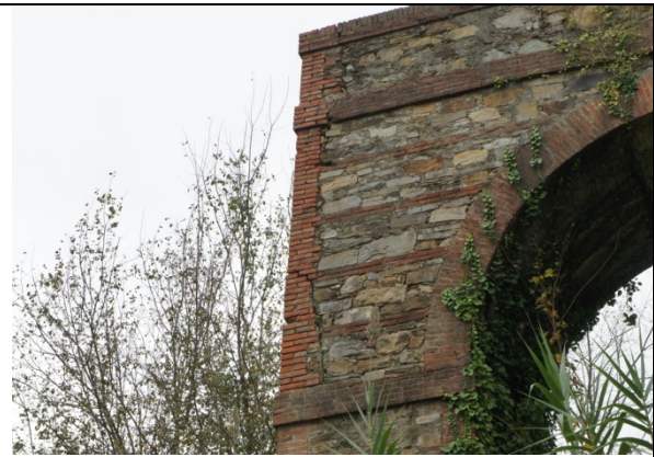
Lesioni nella parte terminale
