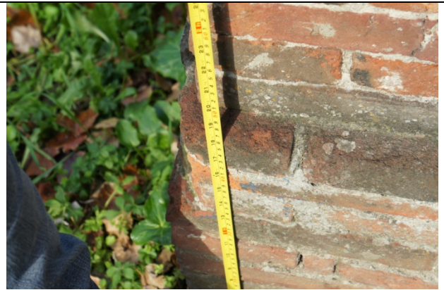
Rilievo posizione verticale delle riseghe 0,5m
