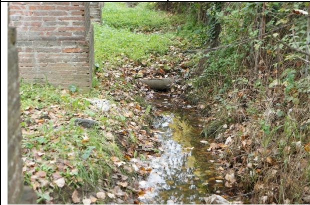
Fosso alla base dell'acquedotto con tubazione non segnalata.
