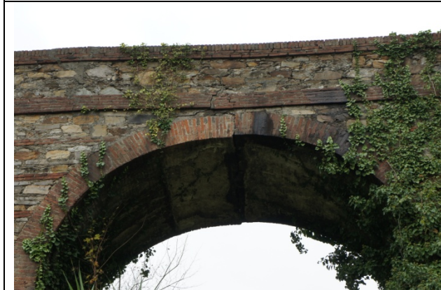
Lesioni dell'arco adiacente al terminale
