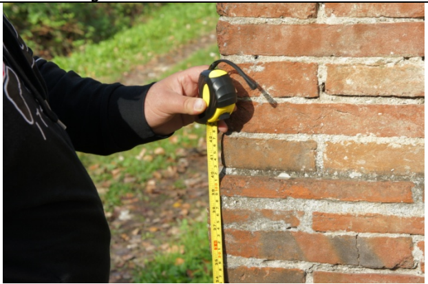
Rilievo posizione verticale delle riseghe 1,0m
