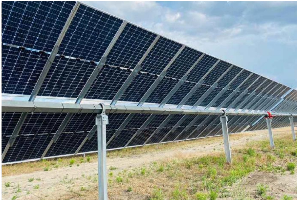
(Esempio di tracker monoassiale montante moduli bifacciali: si scorge il motore per la rotazione in rosso)
