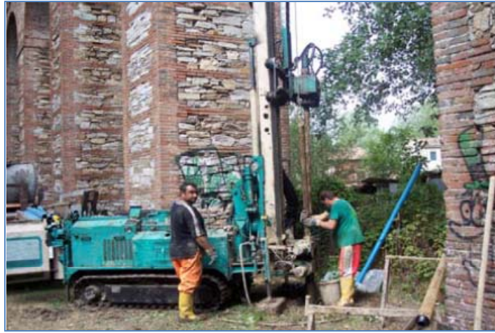
Figura 3.1.2 - Sonda a rotazione modello FRANZA MAF 600 sul tracciato dell'Asse Ovest-Est, tra le arcate dell'Acquedotto del Nottolini ( Indagini geognostiche per Sistema Tangenziale di Lucca – Asse Ovest-Est della Trivelsondaggi S.r.l. )
