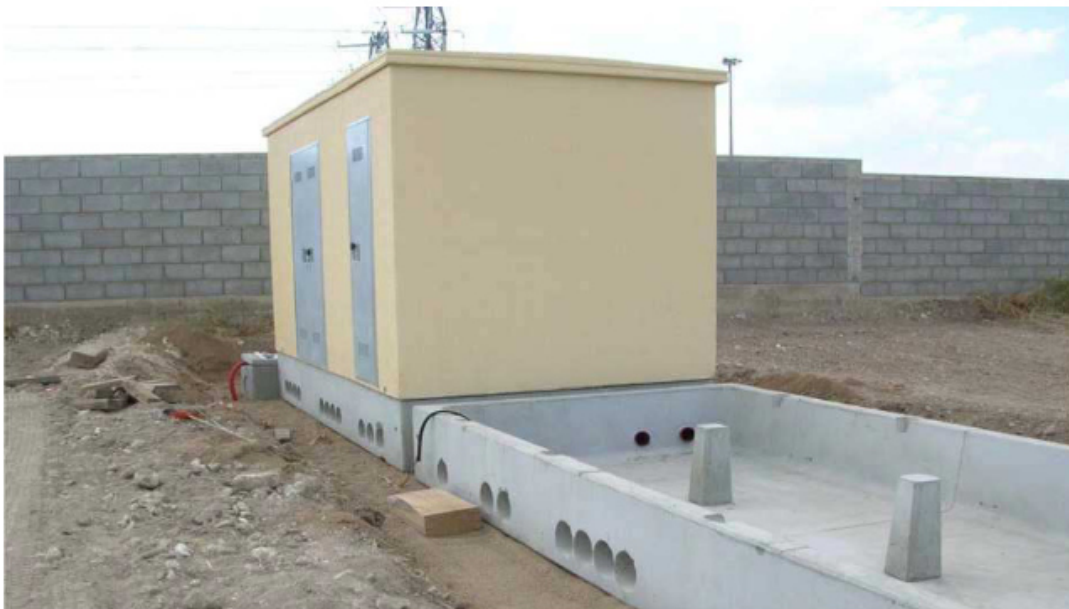
Figura 6-15 Cabina elettrica tipo
