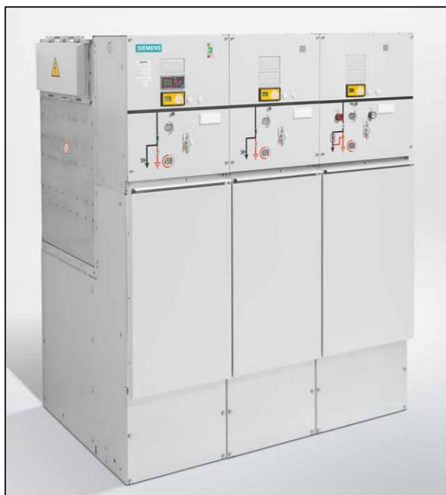
Figura 4 – Quadro elettrico di protezione in MT interno alla cabina di trasformazione
