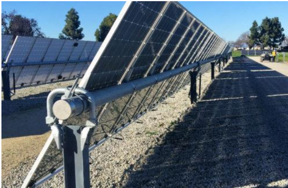
Figura 3.2: Esempio di struttura a tracker monoassiale
