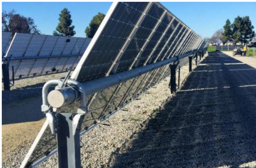
Figura 4.6: Esempio di struttura a tracker monoassiale
