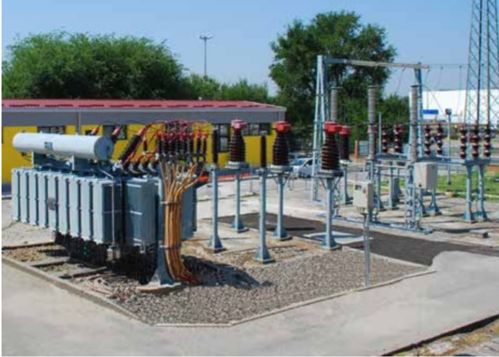
Figura 36-Immagine di riferimento della stazione di trasformazione AT di progetto
