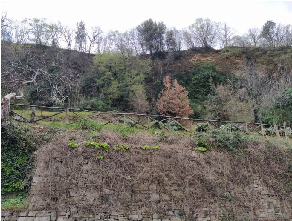
Foto 5-6 – Settore di testata della seconda frana rilevata sulla strada di collegamento Santa Maria- Acquasanta a partire dall'abitato di Santa Maria; si osservi la presenza di un muro in blocchetti realizzato a protezione della strada.
