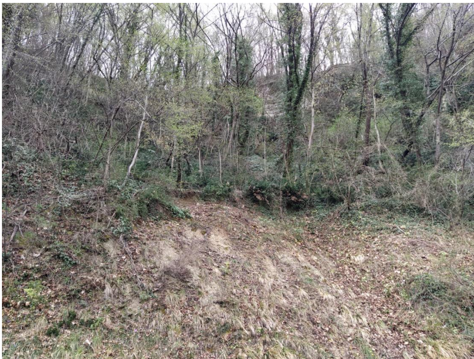
Foto 5-7 – Settore di testata della terza frana osservata sulla strada di collegamento Santa Maria- Acquasanta a partire dall'abitato di Santa Maria; sulla scarpata in basso è visibile il subaffioramento della Scaglia Cinerea.
