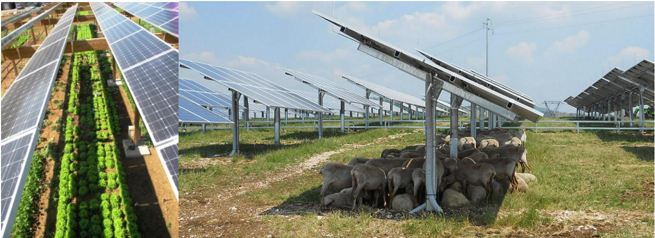
Figura 18 – Tipologie di impianto agro-fotovoltaico
