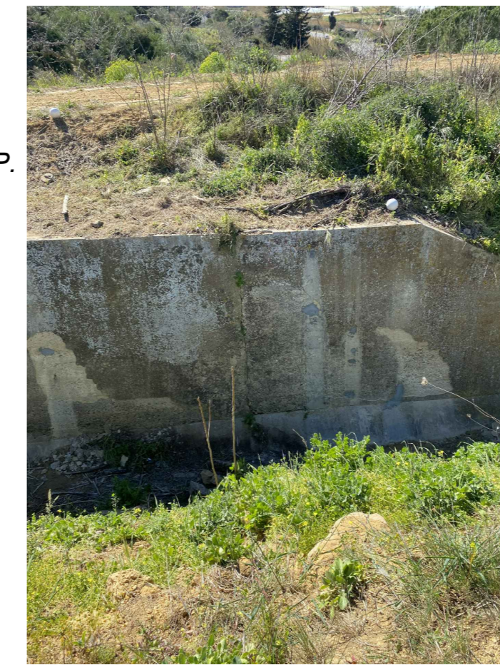
FOTO 3 - Degrado - ammaloramento dovuto a fessurazione.
