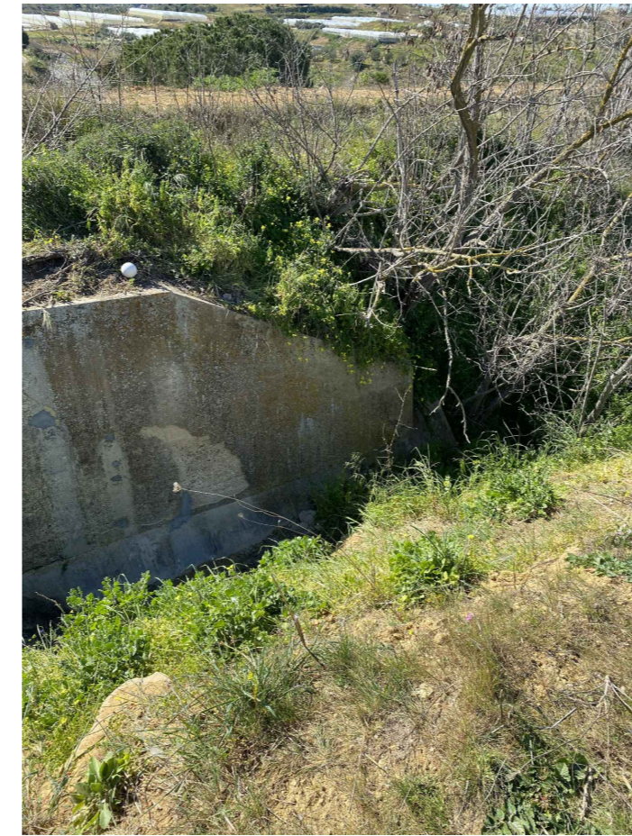
FOTO 1 - Degrado - ammaloramento dovuto a fessurazione.
