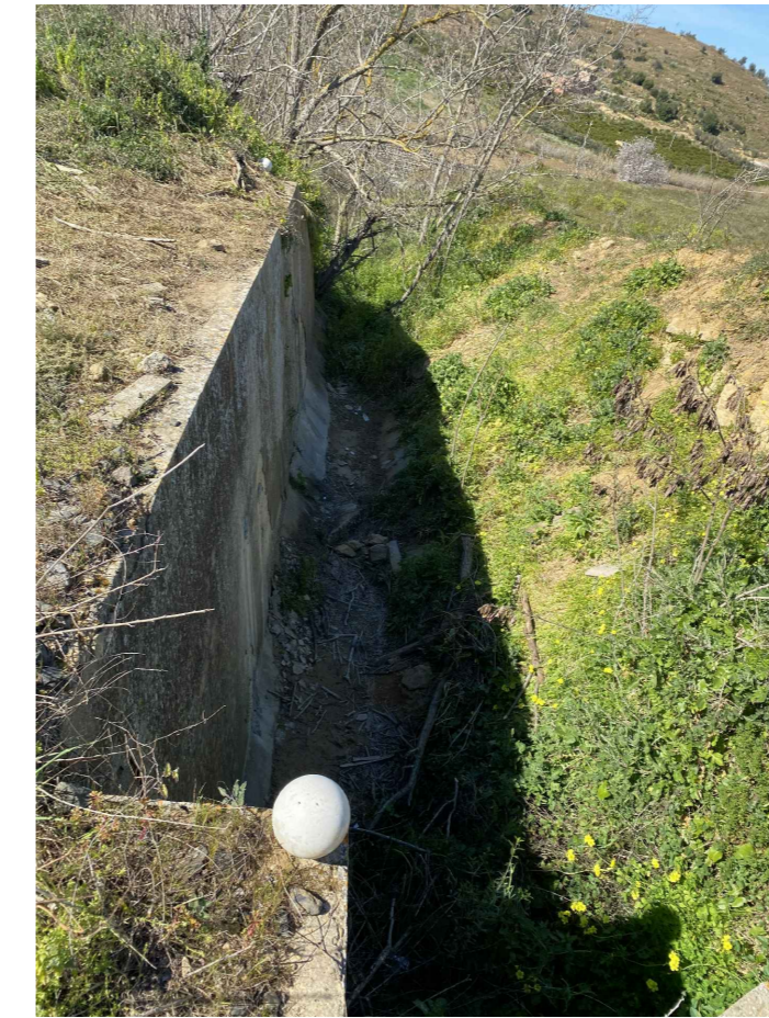
FOTO 2 - Degrado - ammaloramento dovuto a fessurazione.
