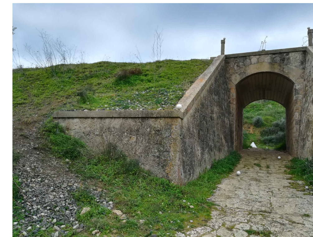
FOTO N.1 - Degrado - ammaloramento dovuto a espulsione cls e armatura a vista pilastri parepette - PROSPETTO LATO VALLE
