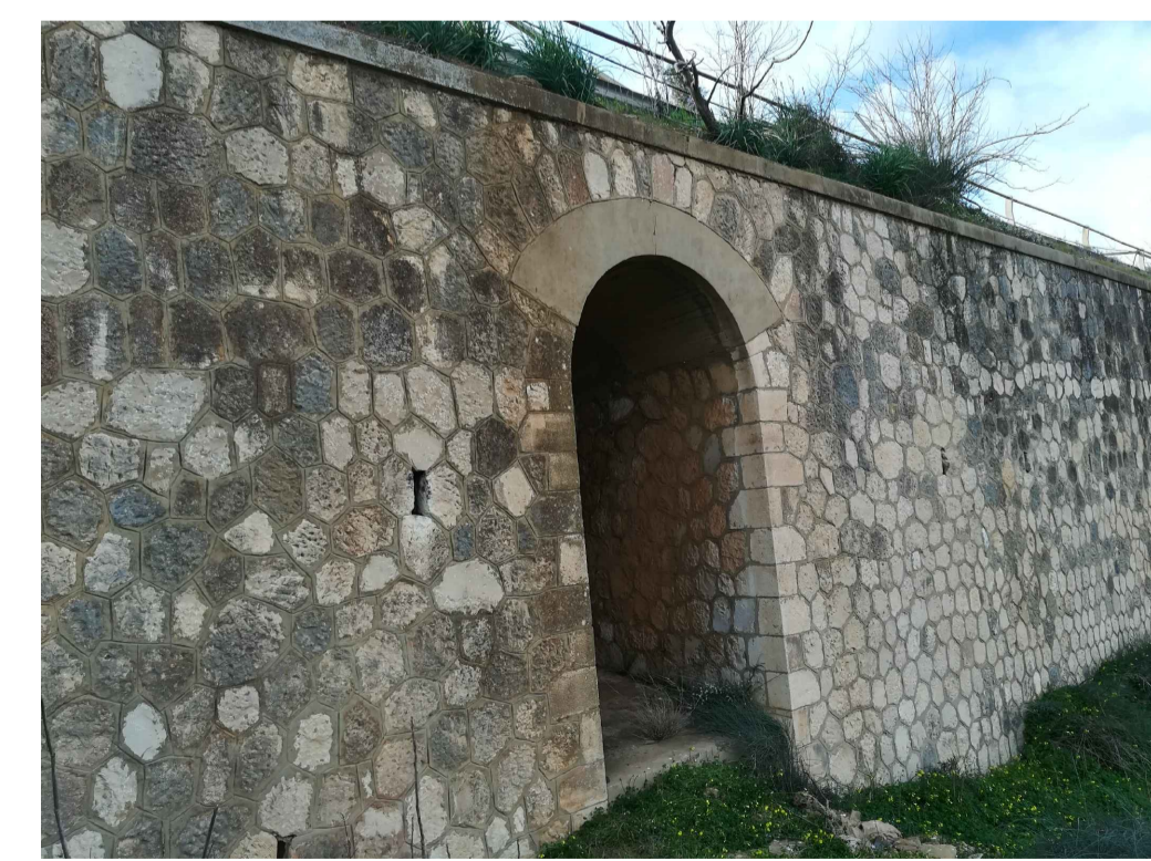
FOTO N.1 - DEGRADO-FESSURAZIONE SU CALOTTA CLS
