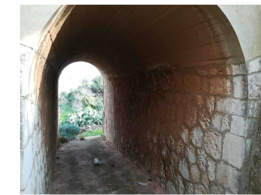
FOTO N.5 - DEGRADO-AMMALORAMENTO DOVUTO A INFILTRAZIONI
