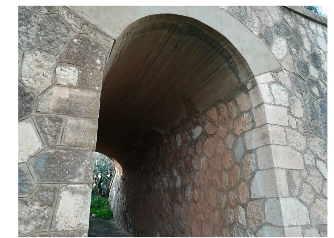
FOTO N.2 - DEGRADO-FESSURAZIONE SU CALOTTA CLS
