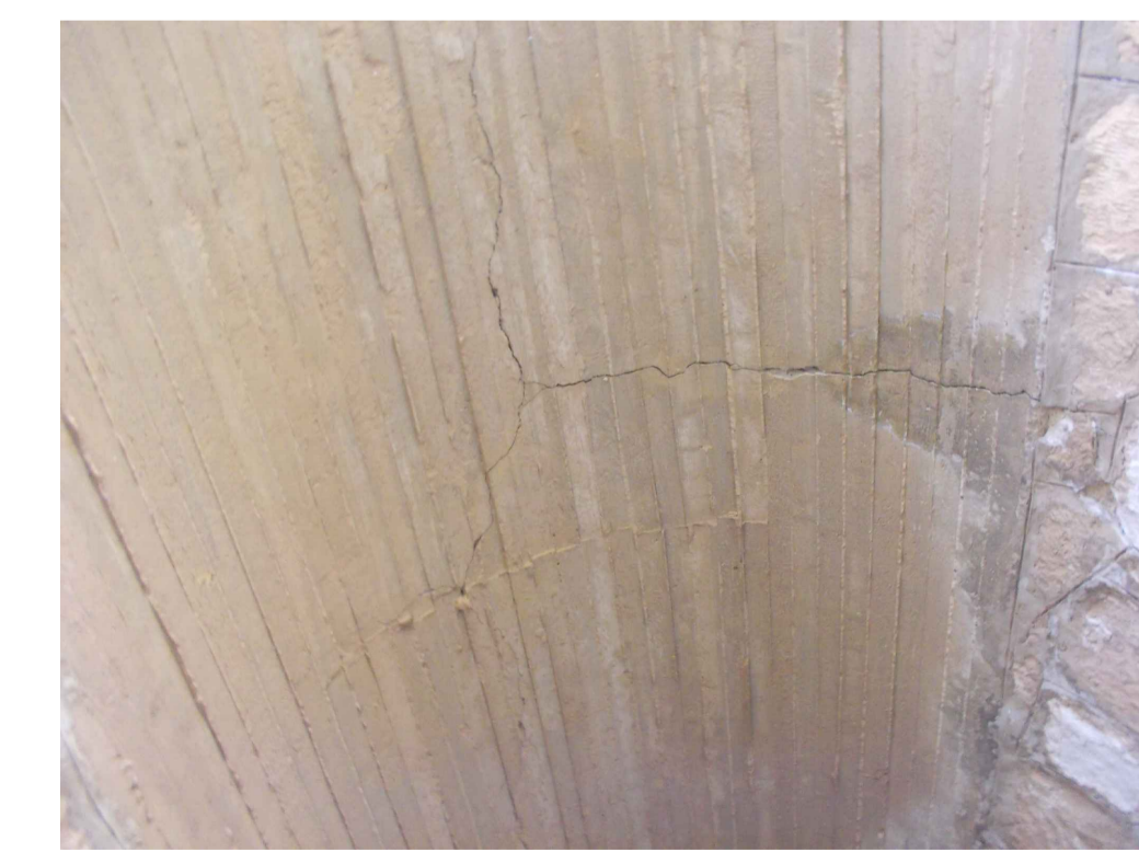
FOTO N.4 - DEGRADO-FESSURAZIONE SU CALOTTA CLS
