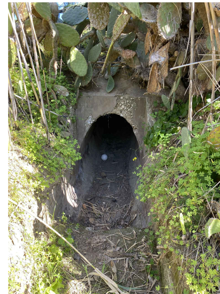
FOTO N.2 - DEGRADO - AMMALORAMENTO CLS - PROSPETTO LATO VALLE
