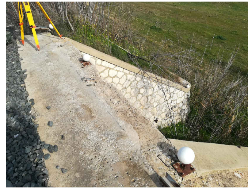
FOTO N.3 - DEGRADO - ASSENZA DI PARAPETTO - PROSPETTO LATO VALLE
