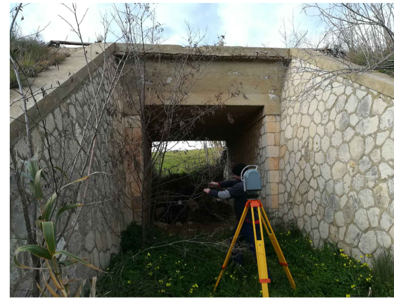
FOTO N.1 - DEGRADO - ESPULSIONI DI CLS - CLS AMMALORATO - PROSPETTO LATO VALLE
