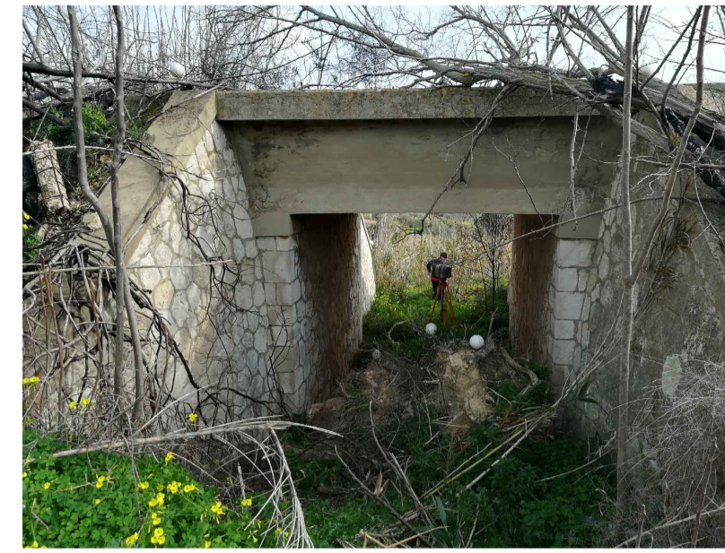
FOTO N.2 - DEGRADO - CLS AMMALORATO - PROSPETTO LATO MONTE
