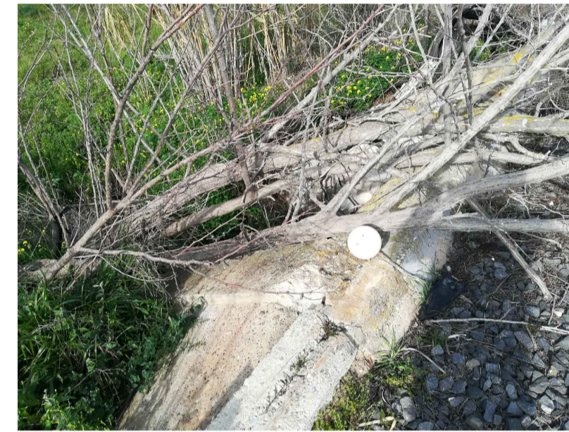
FOTO N.4 - DEGRADO - ASSENZA DI PARAPETTO - PROSPETTO LATO MONTE
