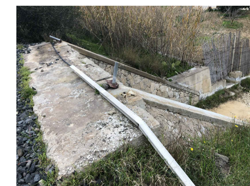
FOTO N.7 - DEGRADO - ASSENZA DI PARAPETTO - LATO VALLE
