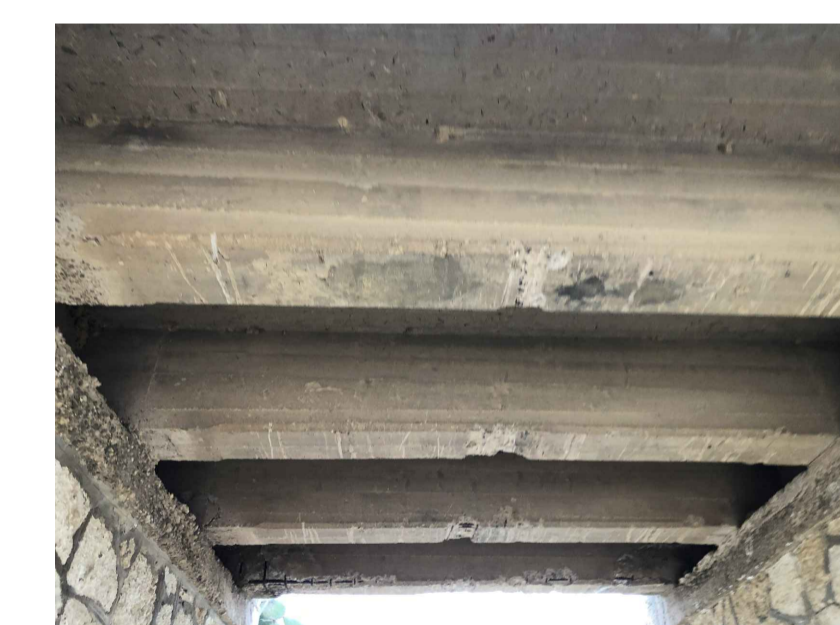
FOTO N.6 - DEGRADO - ESPULSIONE CLS - IMPALCATO (TRAVI IN CA)
