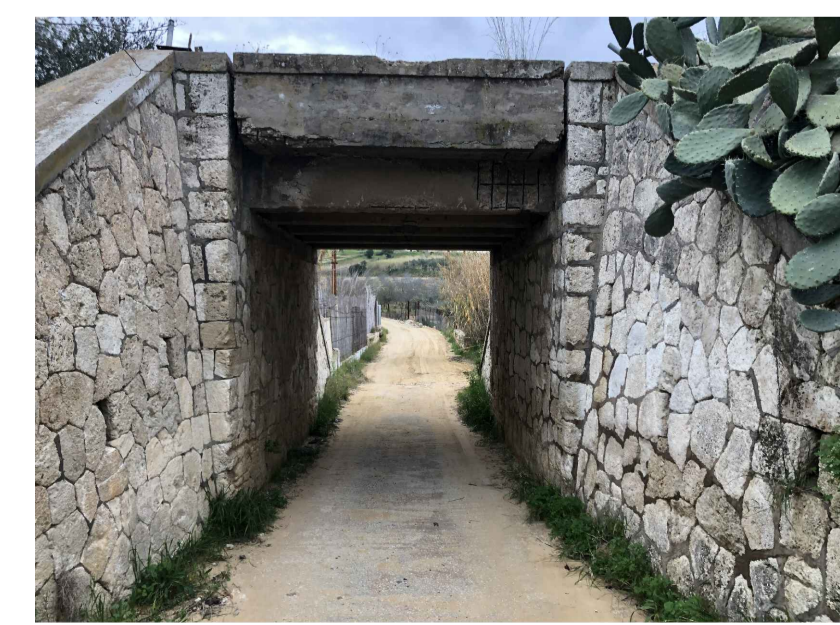
FOTO N.1 - DEGRADO - ESPULSIONE DI CLS - PROSPETTO LATO MONTE
