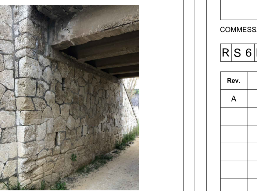
FOTO N.5 - DEGRADO - CLS AMMALORATO - CORDOLO SPALLA LATO NISCEMI
