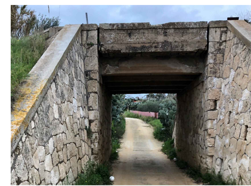
FOTO N.3 - DEGRADO - ESPULSIONE DI CLS - PROSPETTO LATO VALLE
