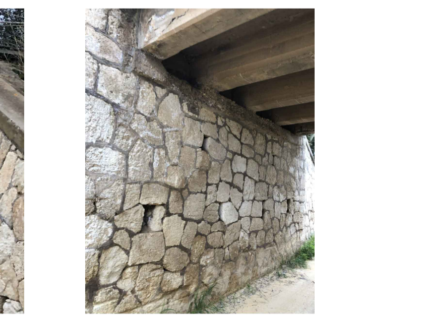
FOTO N.4 - DEGRADO - CLS AMMALORATO - CORDOLO SPALLA LATO GELA
