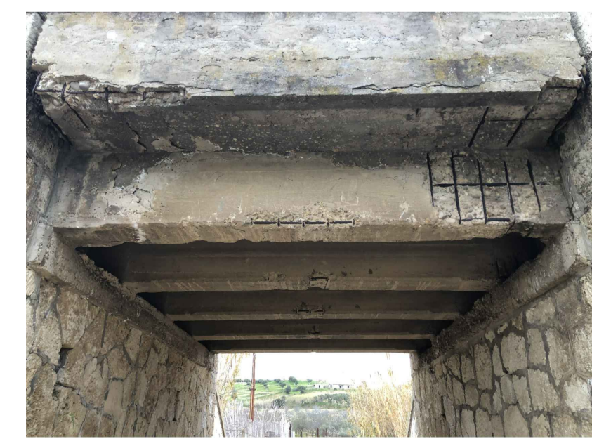
FOTO N.2 - DEGRADO - ESPULSIONE DI CLS - PROSPETTO LATO MONTE
