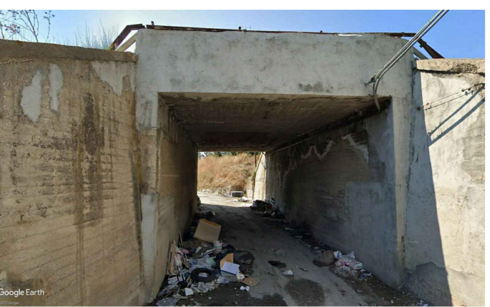
FOTO N.3 - Degrado - Assenza parapetto PROSPETTO LATO MONTE
