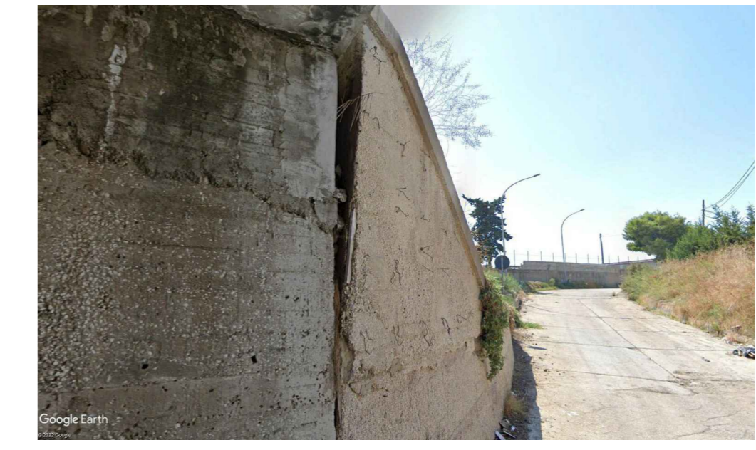
FOTO N.1 - Distacco muro d'ala - PROSPETTO LATO VALLE
