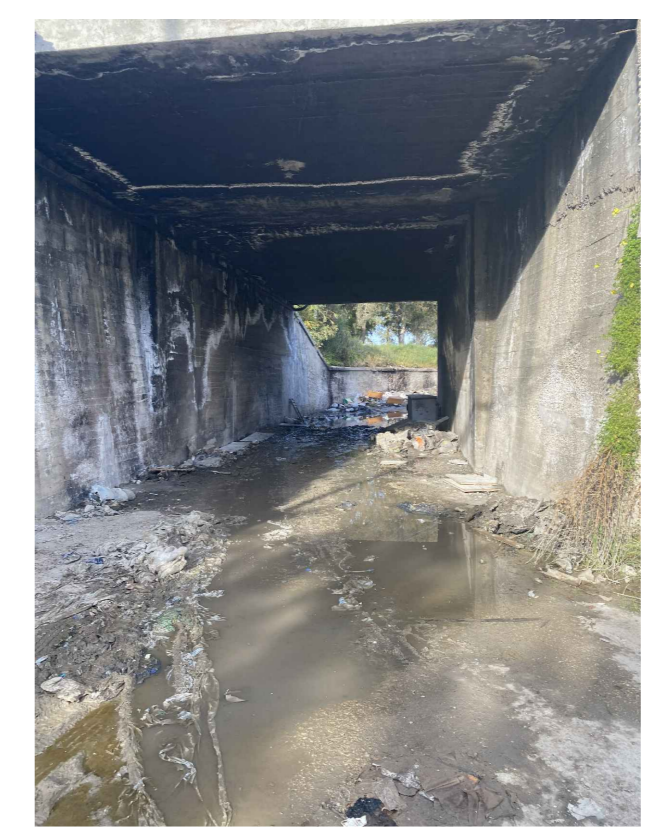
FOTO N.2 - Degrado - ammaloramento dovuto infiltrazione - incendio
