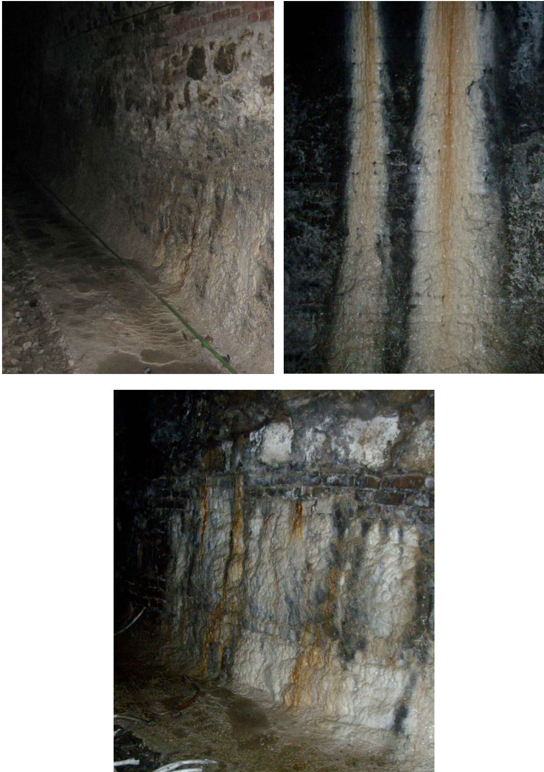
Figura 12 - Venute d'acqua e stillicidi con deposito di materiale
