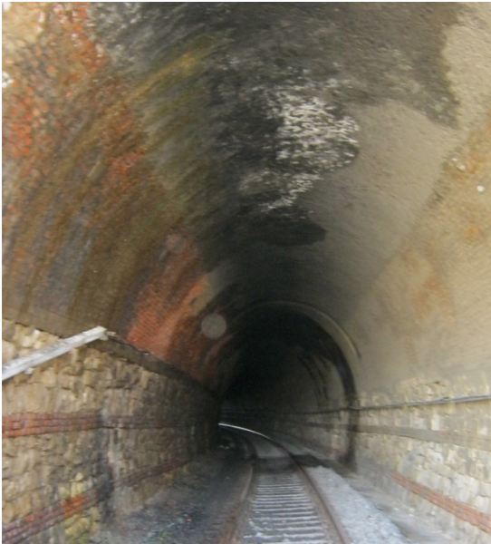
Figura 19 - Degrado asimmetrico delle malte (calottino con un leggero strato di gunite)
