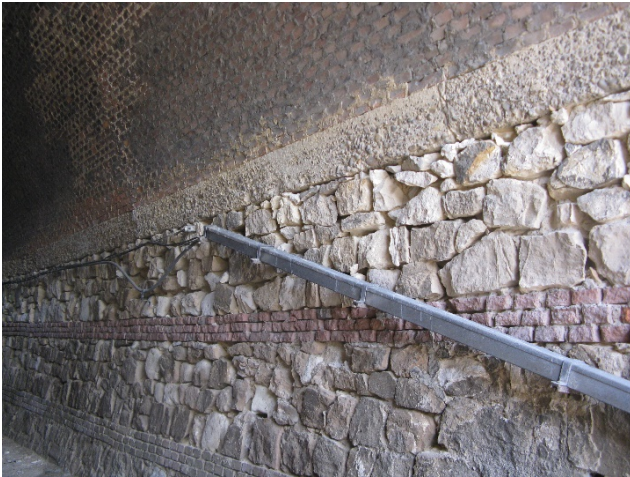
Figura 14 - Malta assente o degradata tra i vari elementi dei rivestimenti
