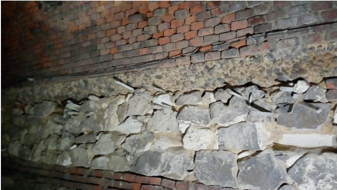
Figura 17 - Cunei di legno tra i blocchi di muratura – Galleria 2a di Farello
