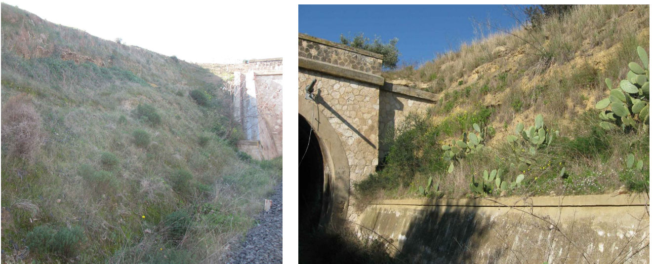
Figura 6 – Situazioni tipologiche degli imbocchi: muri d'ala non sempre adatti alla morfologia esistente
