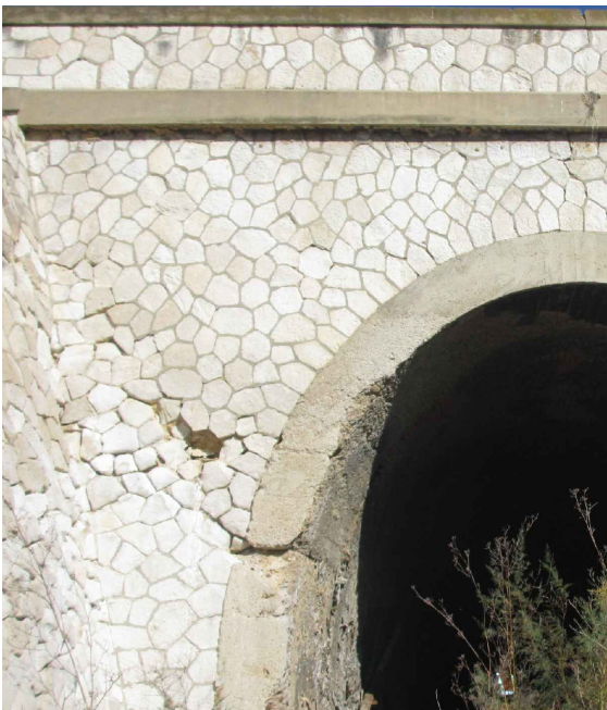
Figura 9 - Distacco del rivestimento al portale
