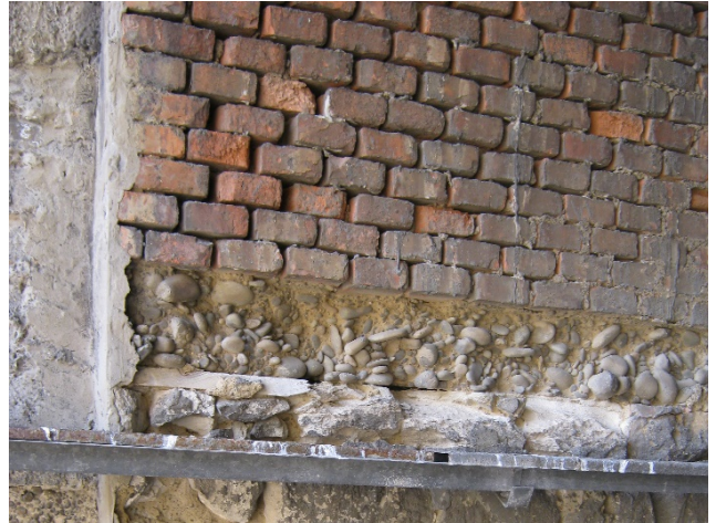
Figura 15 - Degrado delle malte tra i mattoni della calotta e inerti di grandi dimensioni – Galleria 2a di Farello
