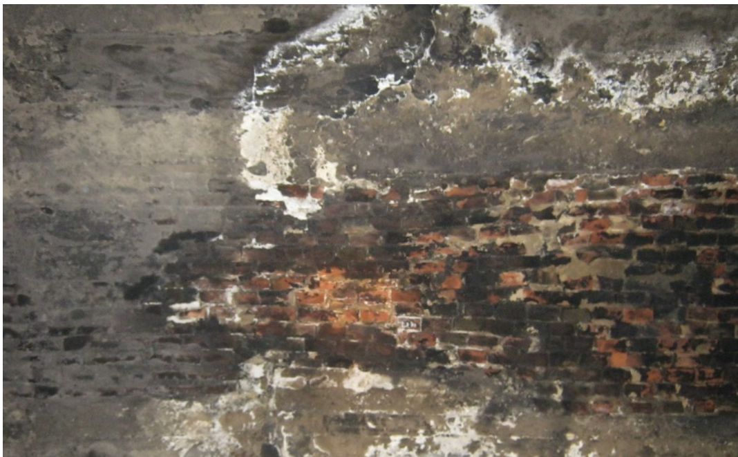
Figura 5 – Calotta in mattoni con umidità e muffe.
