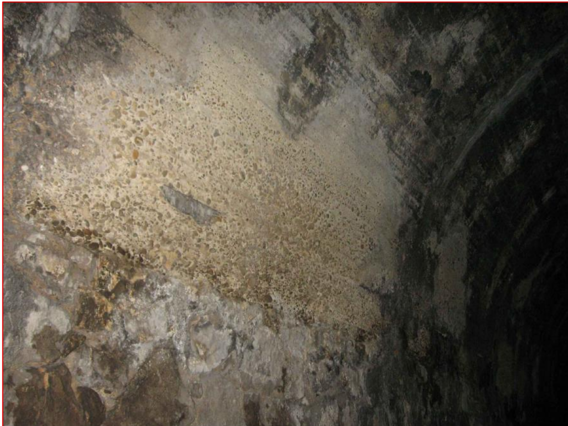
Segregazione d'inerti tra calotta e piedritto SX (C1)
