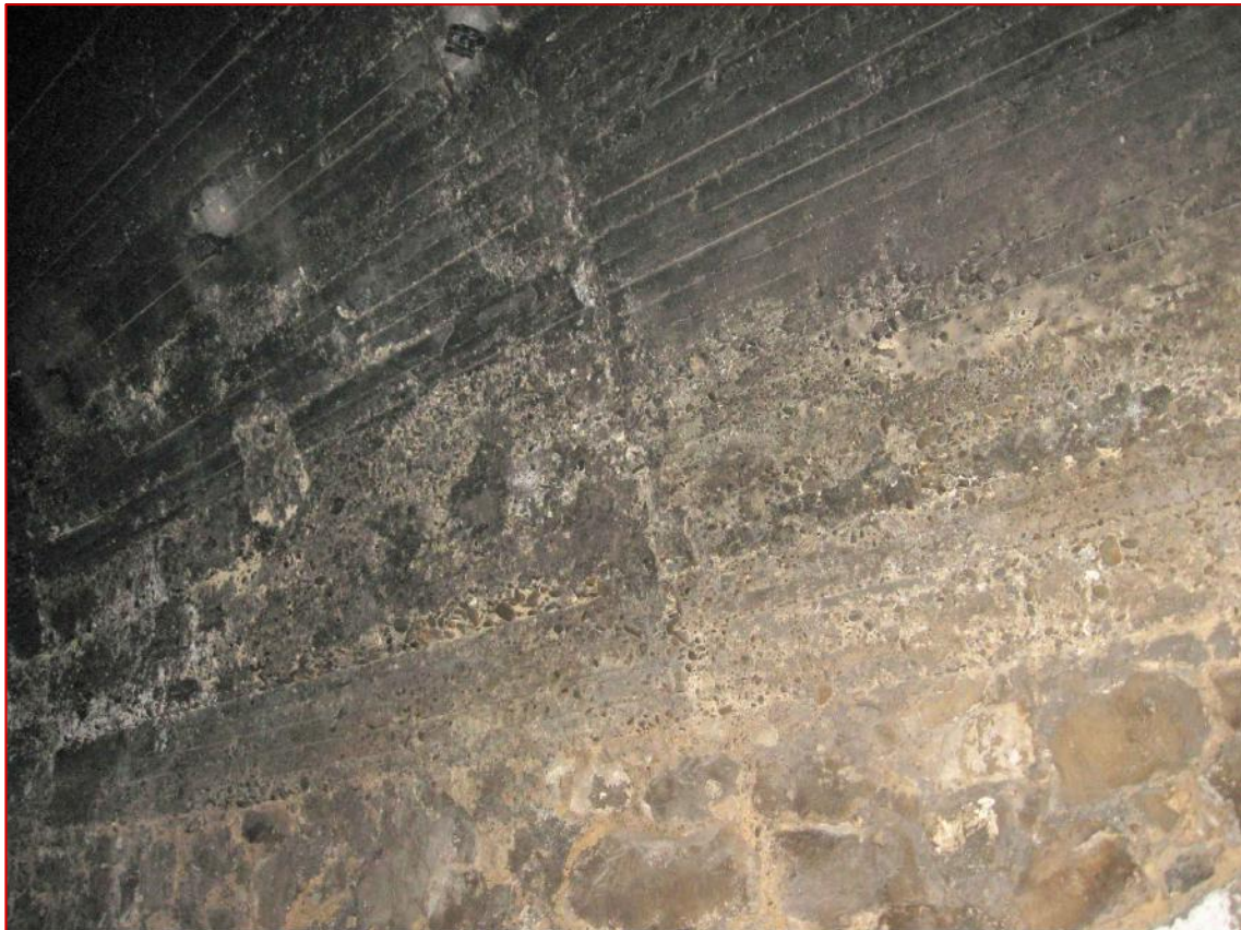
Segregazione d'inerti tra calotta e piedritto DX (C1)
