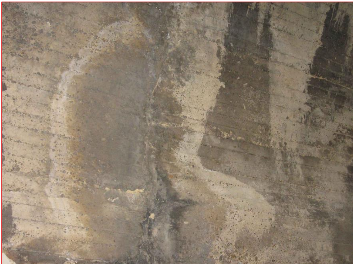
Aree umide e fessurazione trasversale in calotta (C4, C16)
