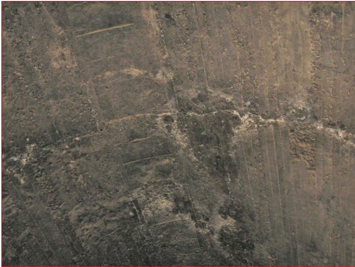
Fessurazione in calotta (C16)
