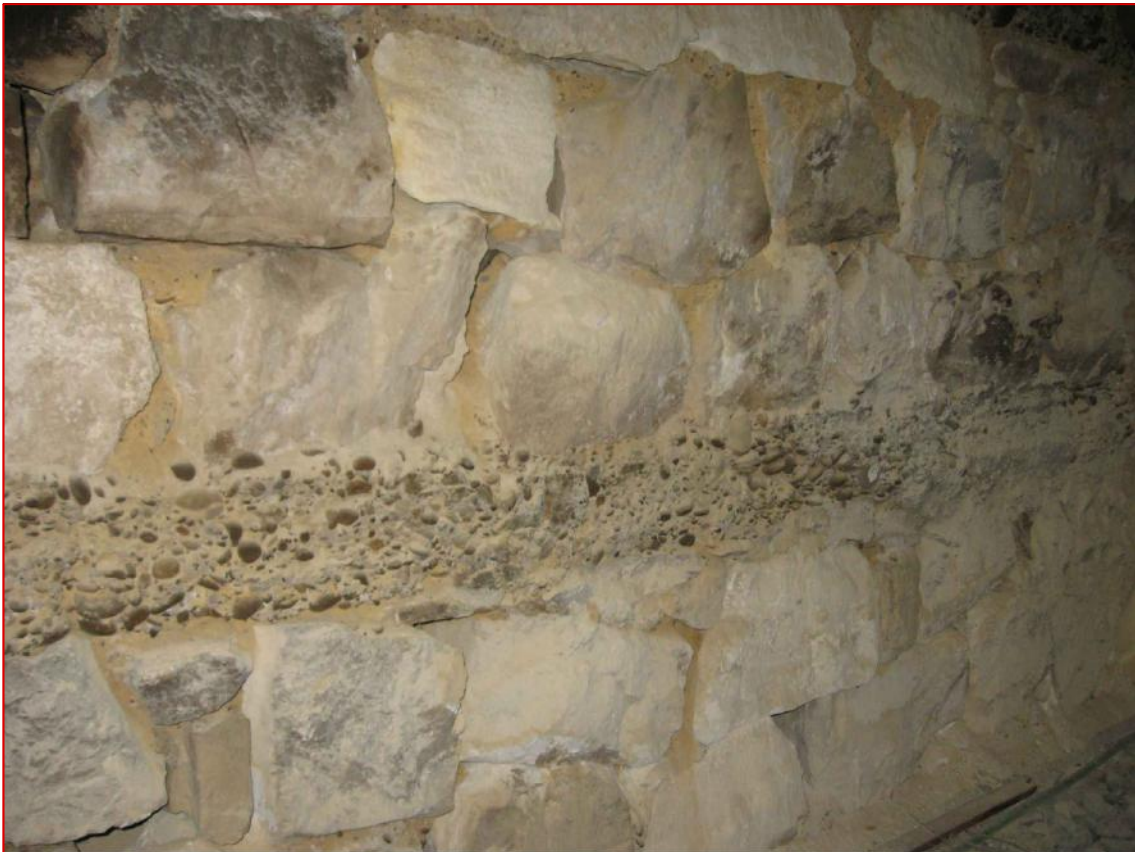
Polverizzazione della malta sul piedritto SX
