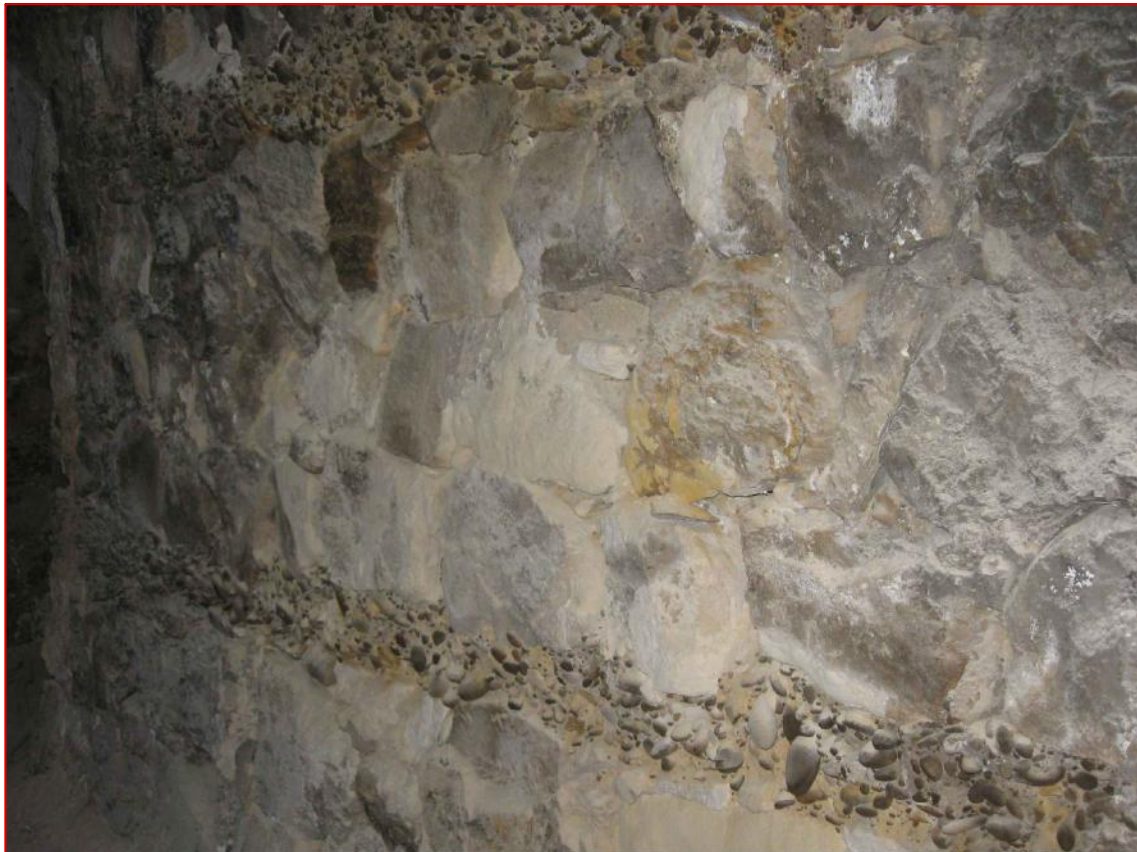
Polverizzazione della malta sul piedritto DX (M6)
