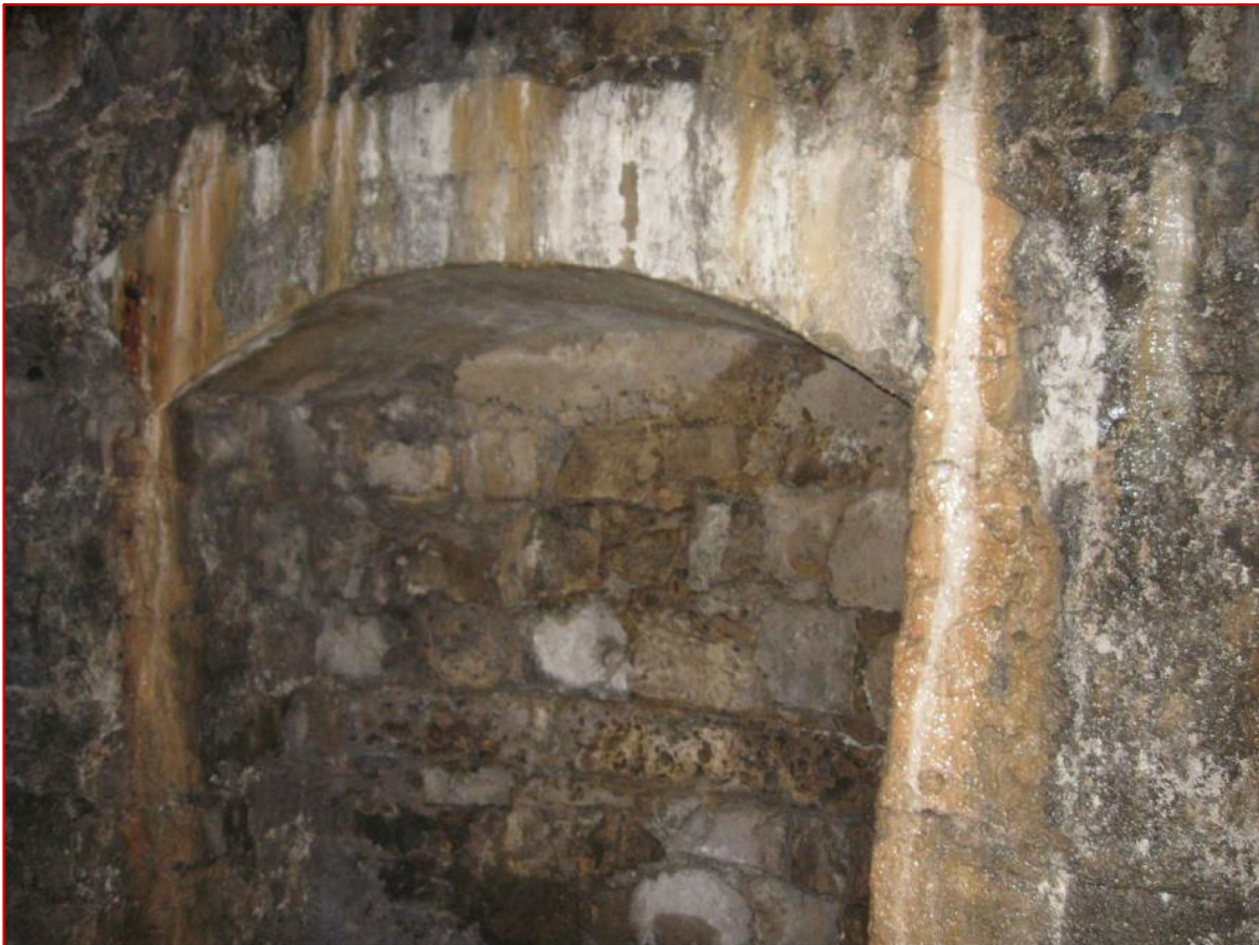
Aree umide, venute d'acqua e concrezione nella nicchia n.15 lato DX (M1, M7)
