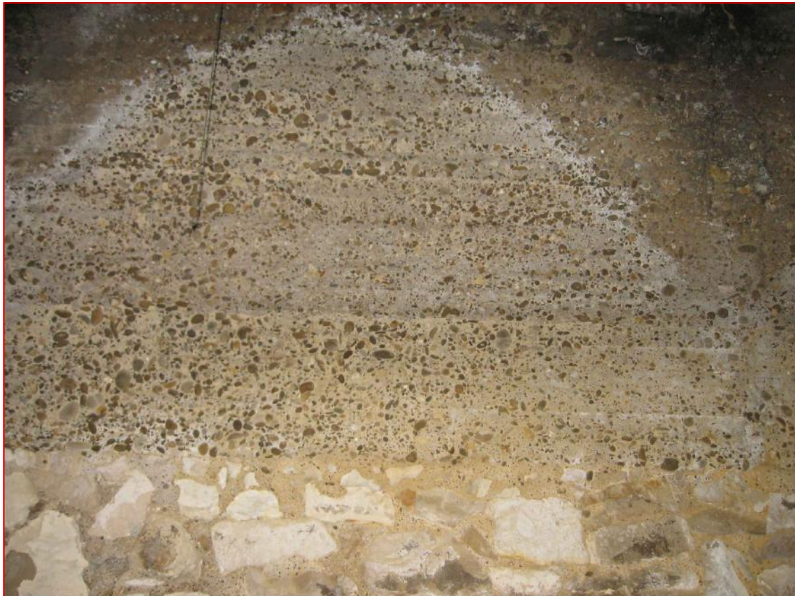
Segregazione tra calotta e piedritto DX (C1)
