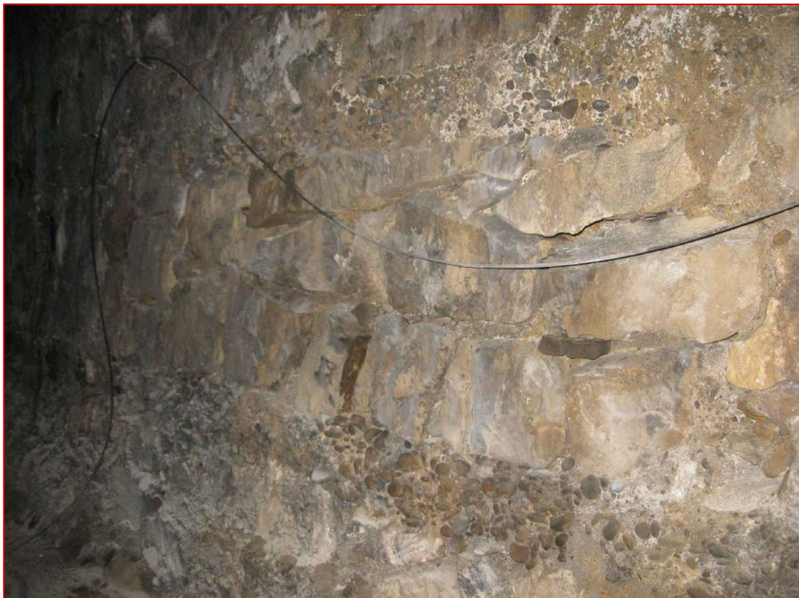
Polverizzazione della malta sul piedritto DX (M6)
