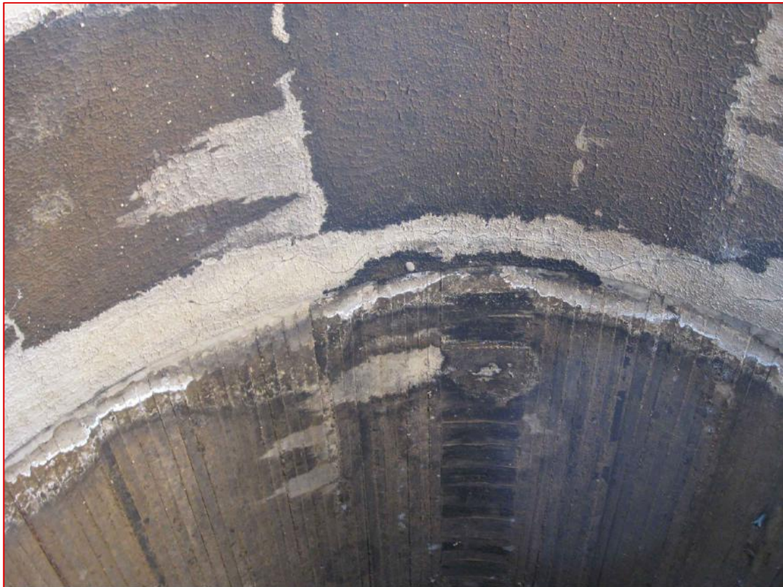
Fessurazione trasversale in calotta (C16)
