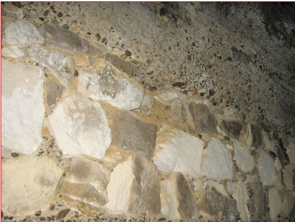
Segregazione d'inerti in calotta e polverizzazione della malta sul piedritto SX (C1, M6)
