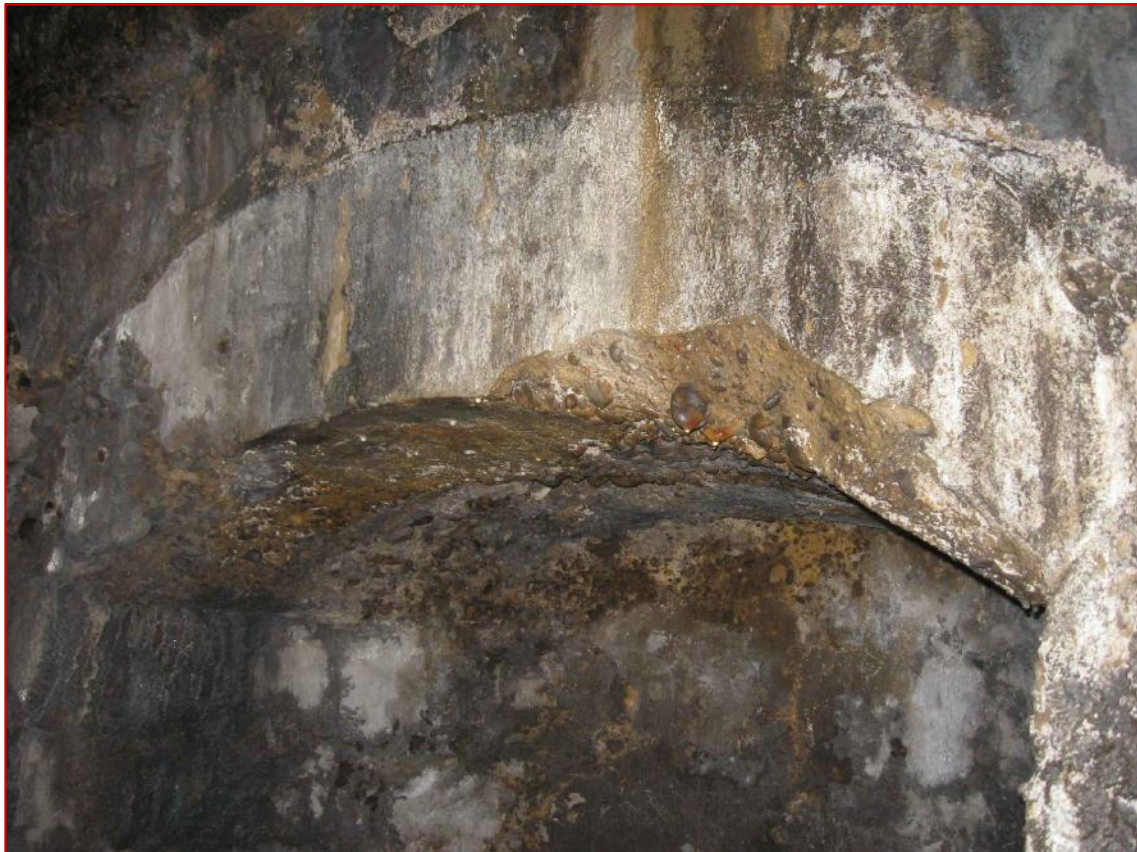
Aree umide, venute d'acqua, concrezione e segregazione d'inerti sulla nicchia n. 17 (M1, M7, C1)
