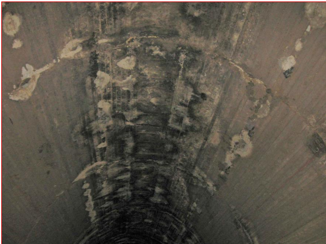
Aree umide e fessurazioni in calotta (C4, C16)
