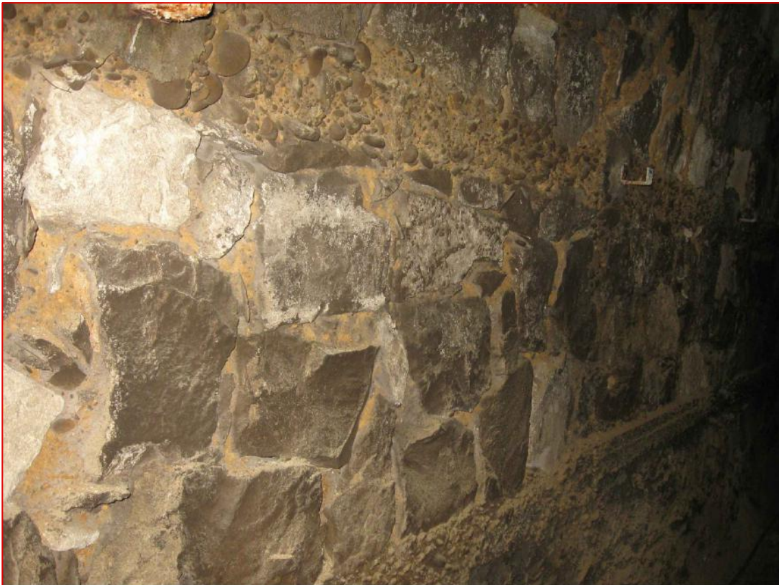
Polverizzazione della malta sul piedritto SX (M6)
