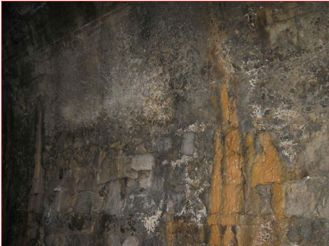
Aree umide, venute d'acqua, concrezione e polverizzazione della malta sul piedritto DX (M1, M7, M6)
