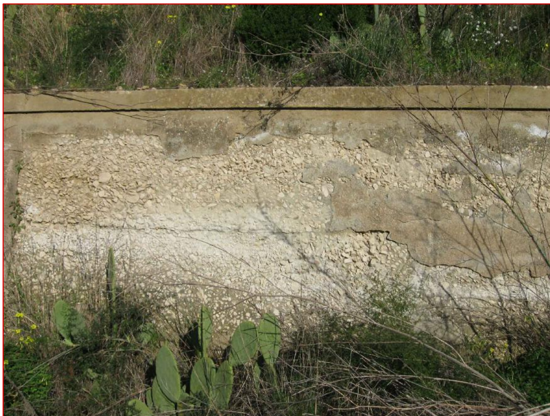
Segregazione d'inerti su muro d'ala DX
