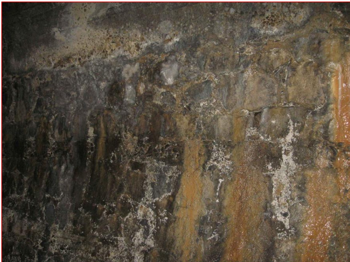
Aree umide, venute d'acqua e concrezione sul piedritto DX (M1, M7)
