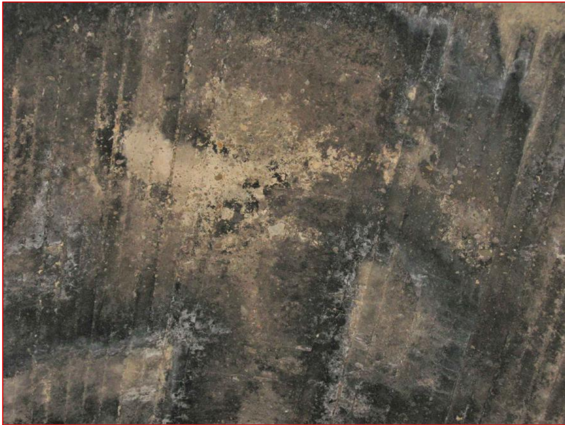
Aree umide e segregazione d'inerti in calotta (C4, C1)
