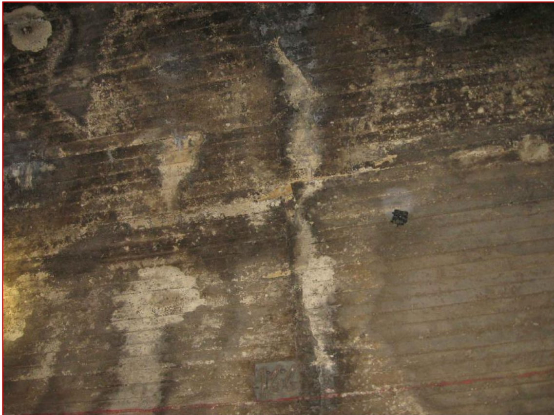
Aree umide e fessurazioni trasversali in calotta (C4, C16)
