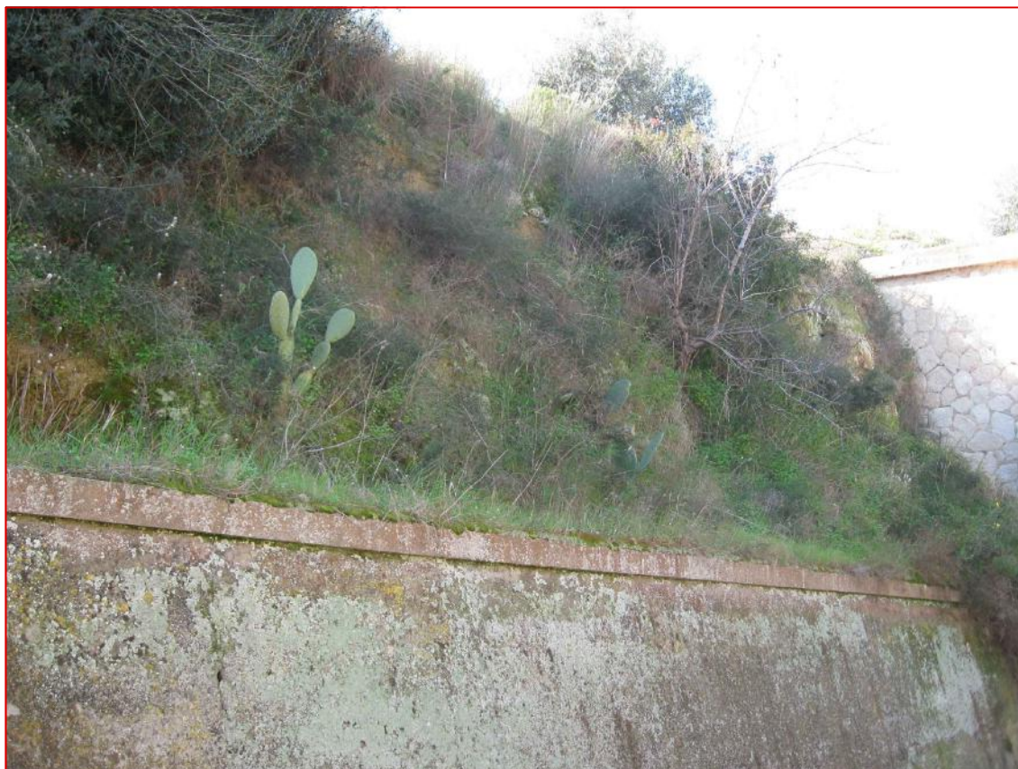
Dettaglio scarpata SX
