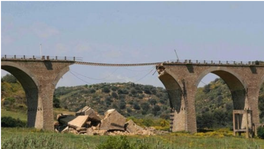
Figura 4 – Foto del viadotto crollato nel 2011.
