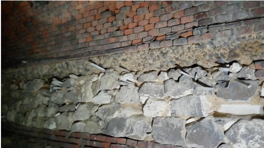
Figura 37 - Cunei di legno tra i blocchi di muratura – Galleria 2a di Farello
