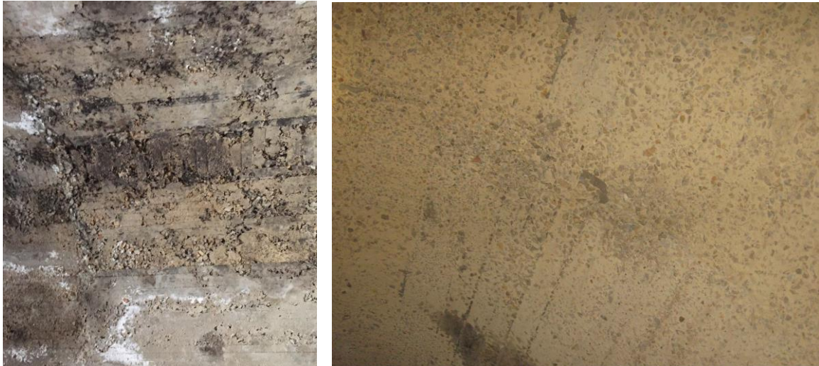
Figura 39. Vespai in calotta e segregazione degli inerti in calotta
