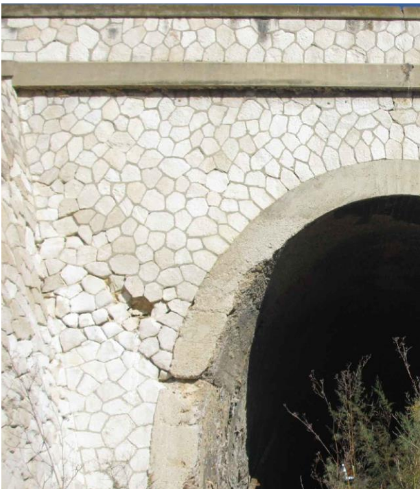
Figura 42. Distacco del rivestimento al portale
