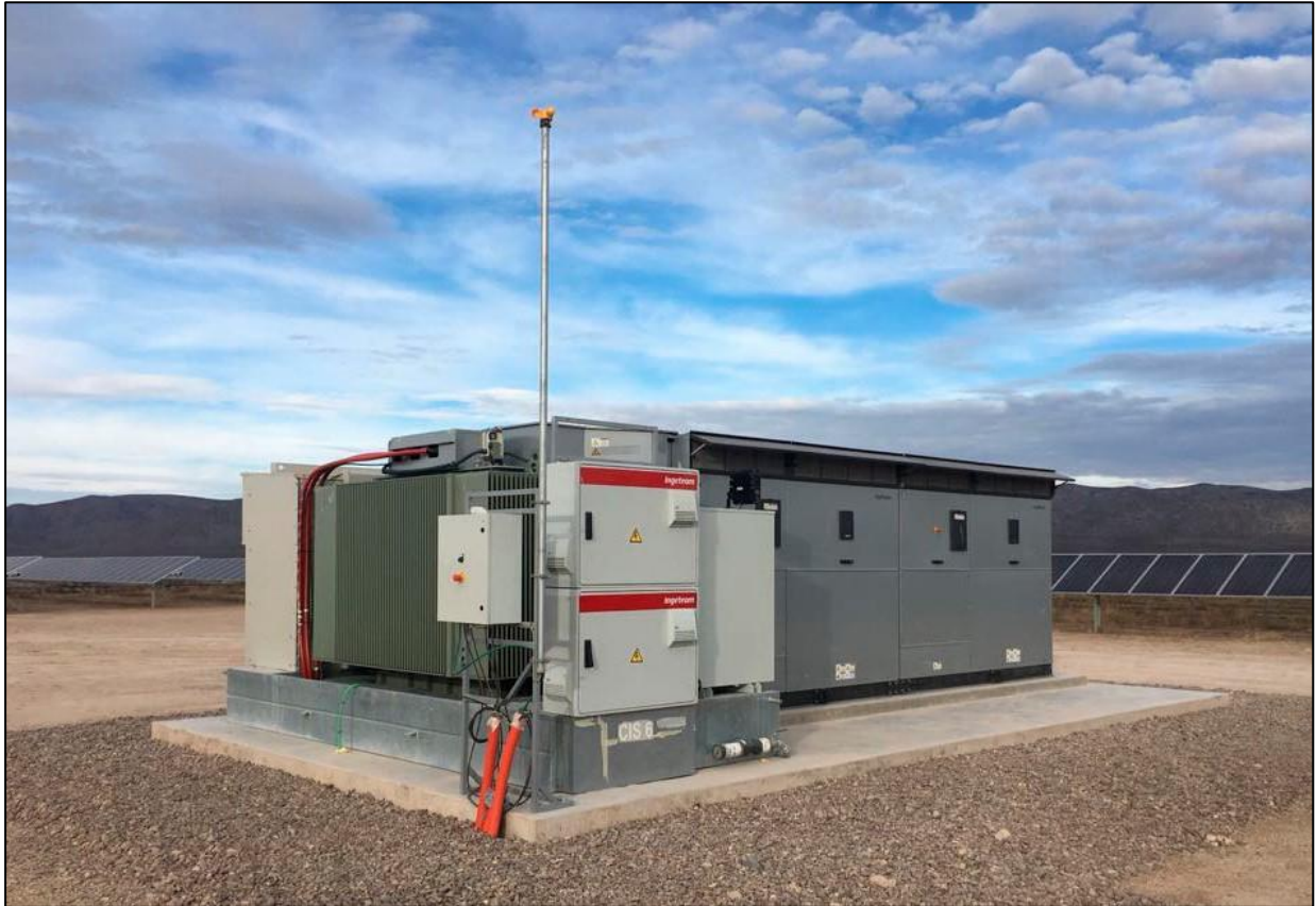
Fig. 45: Cabine di trasformazione
