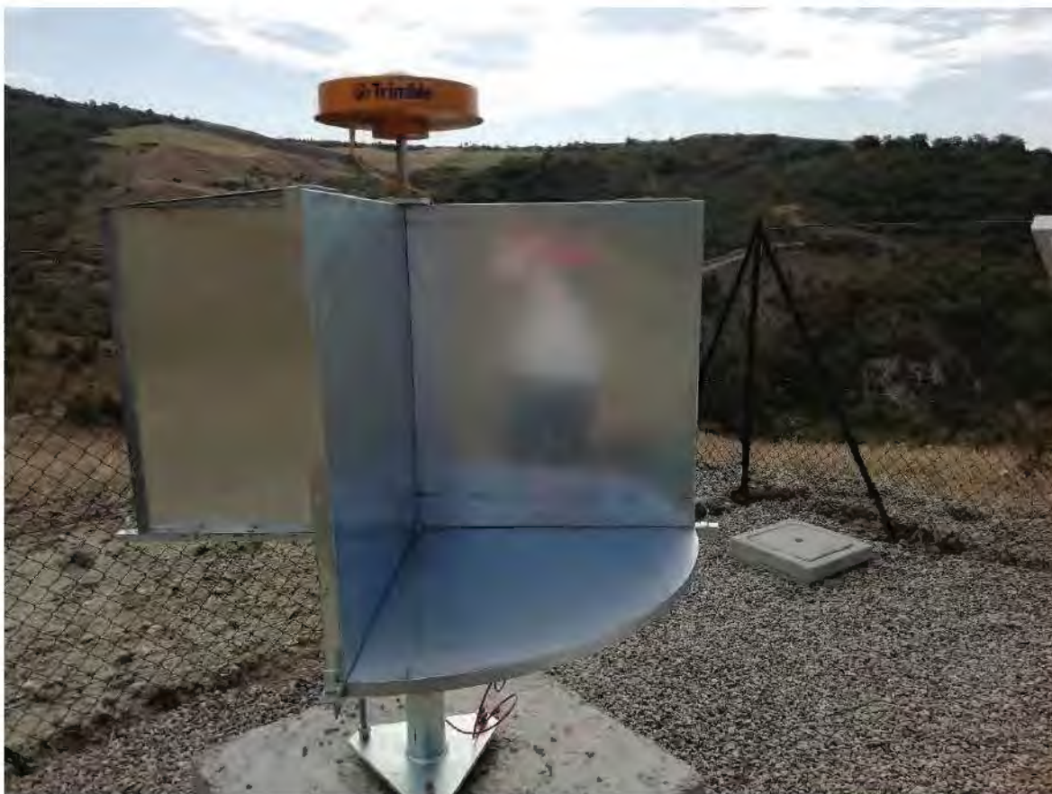
Esempio di antenna GNSS Choke Ring installata alla sommità di un riflettore satellitare passivo in un'area interessata da estrazione di idrocarburi.
