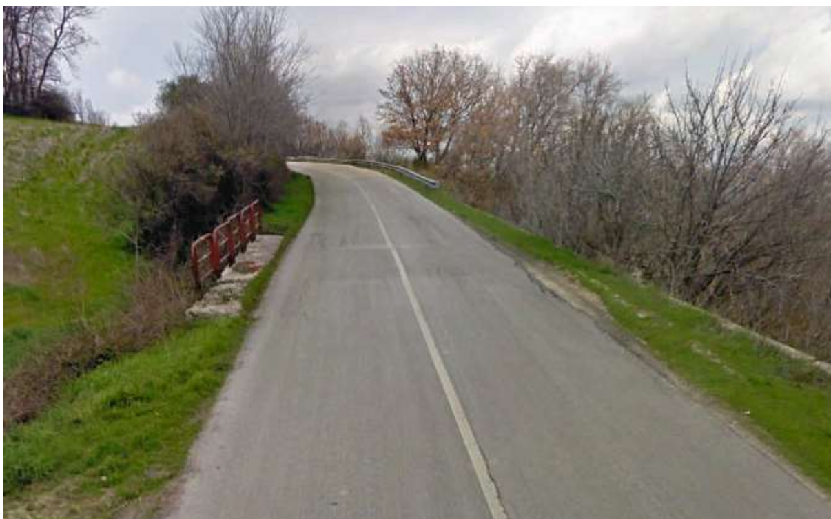
Figura 44. Opera di attraversamento in corrispondenza della viabilità esistente per il collegamento con la WTG 1 (475992.01 m E, 4634406.83 m N) .
