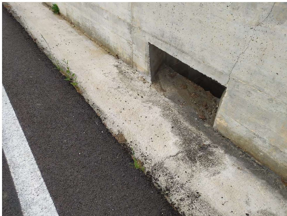
Figura 24. Canale di raccolta in corrispondenza della SS della Valle del Biferno.
