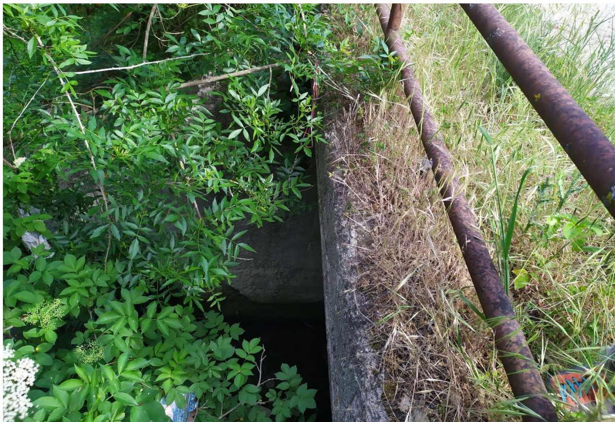
Figura 48. Opera di attraversamento in corrispondenza della viabilità esistente sulla strada comunale "macchialonga" per il collegamento delle WTG 6 e WTG 7 (478981.29 m E, 4635839.15 m N)
