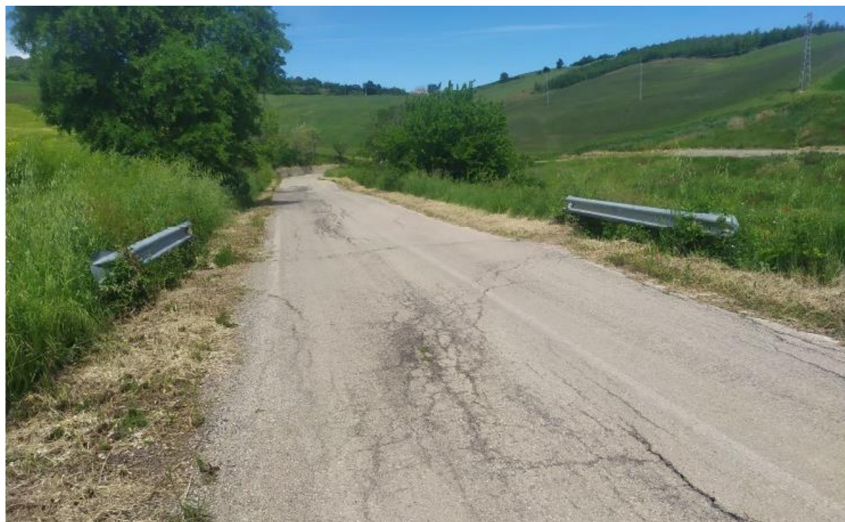
Figura 39- Vista dal punto P27: stato dei luoghi dove verrà posato il cavidotto in MT. Il cavidotto si svilupperà lungo la strada esistente SP13
