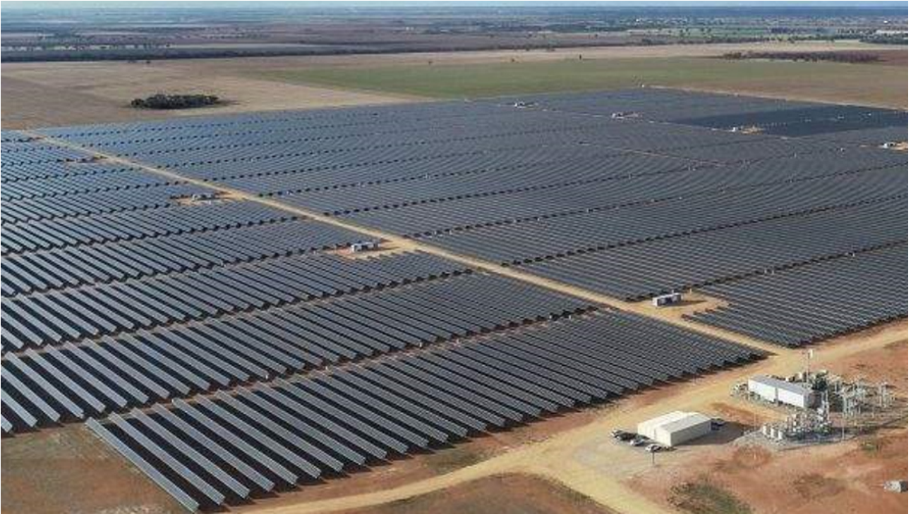
Esempio di impianto fotovoltaico installato su tracker monoassiali
