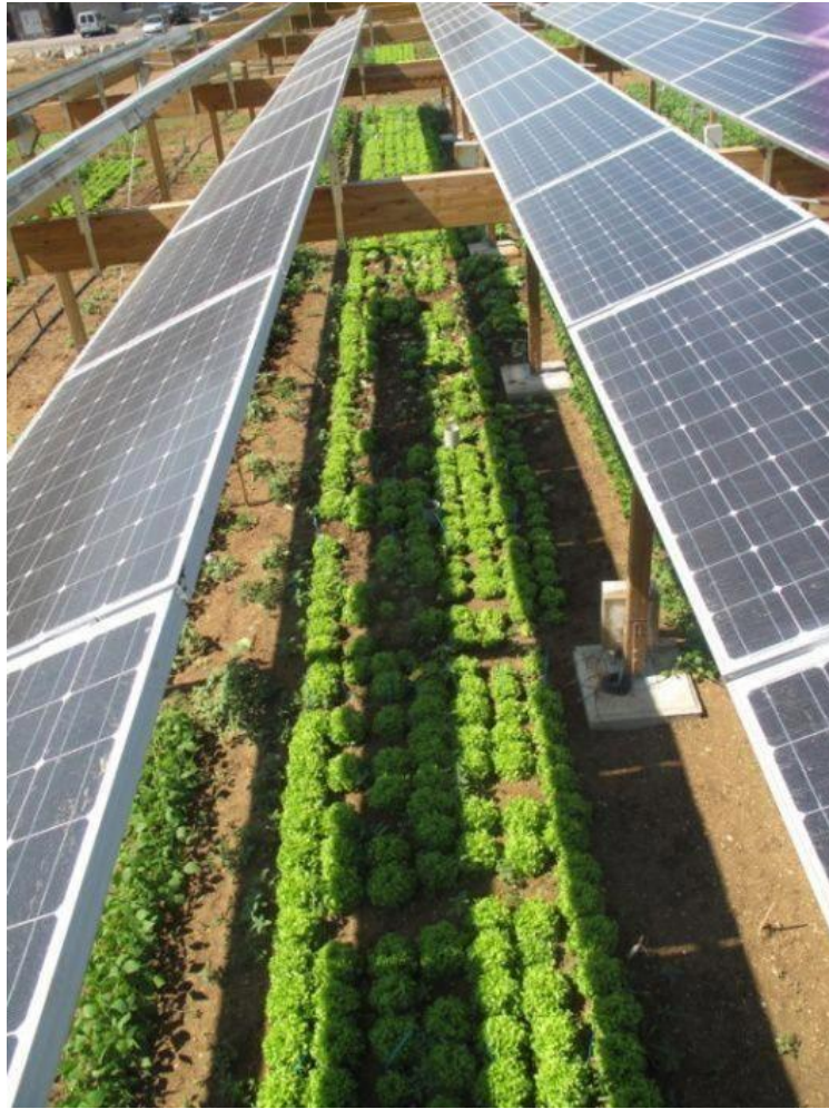
Fig 3.22 – Esempio di Impianto Agrovoltaiico
