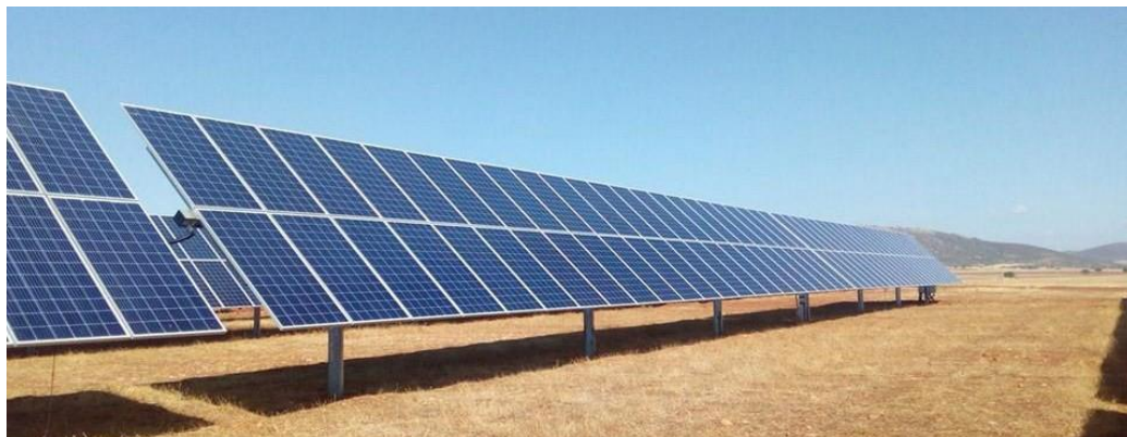
Figura 7 - Particolare del tracker in oggetto
