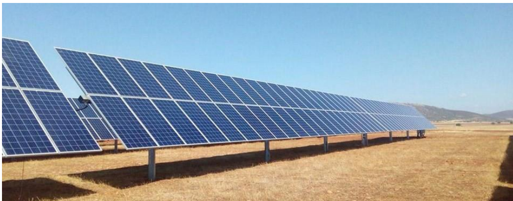
Figura 7 - Particolare del tracker in oggetto
