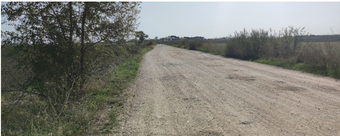
Viabilità in conglomerato bituminoso esistente in pessimo stato
