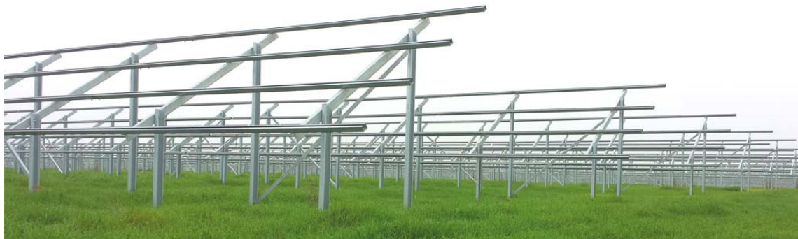
Figura 9 - Strutture di sostegno dei pannelli fotovoltaici
