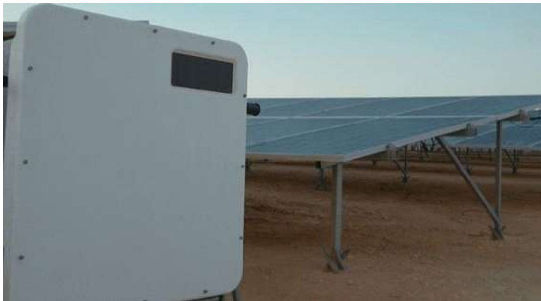
Inverter con pannelli – foto esemplificativa
