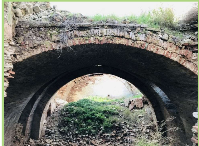
Foto 28. Abbazia di Sant'Agata, particolare dell'interno in grave stato di abbandono. Piano terra.
