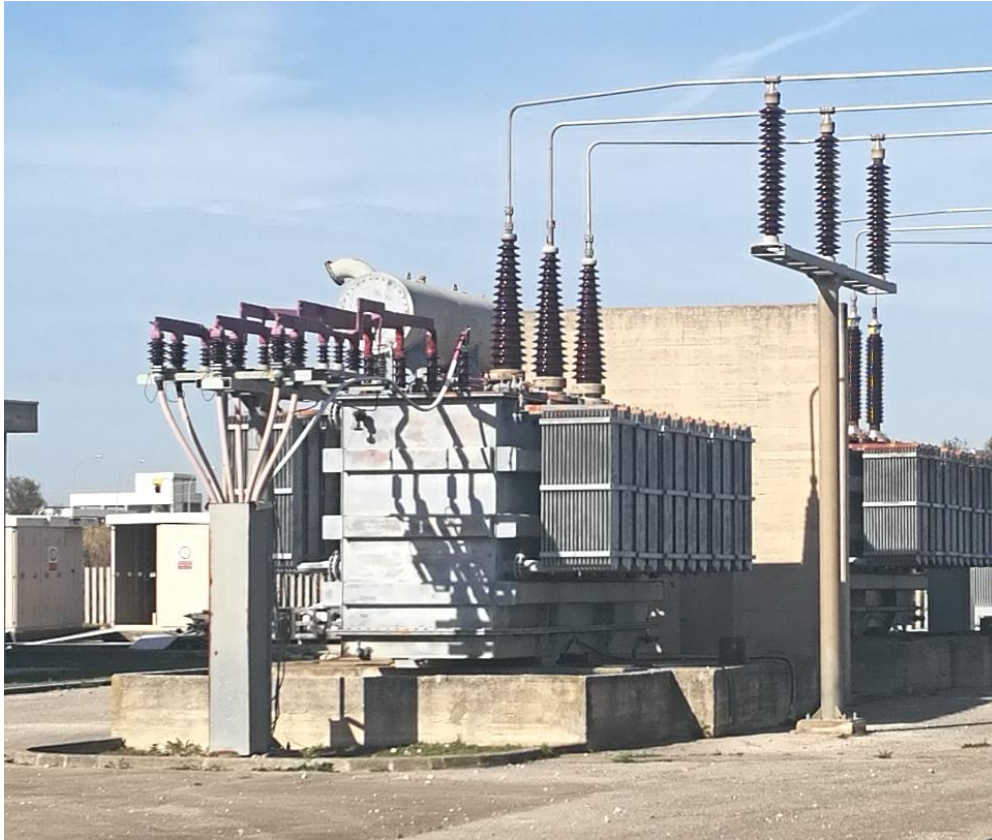
Trasformatore di potenza 40MVA 150/20kV
