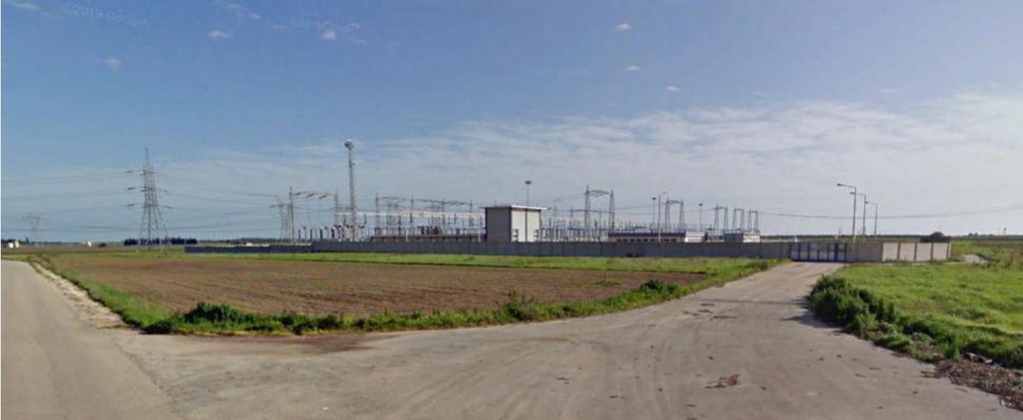
Vista dalla della Stazione Elettrica "Brindisi Sud" dalla SP 81
