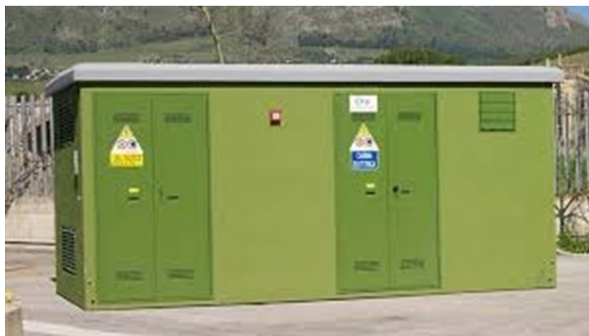
Cabina prefabbricata tipica utilizzata in progetto
